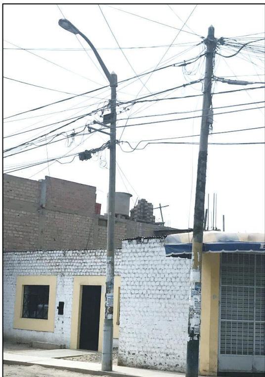
Figura 6 Poste de alumbrado público
