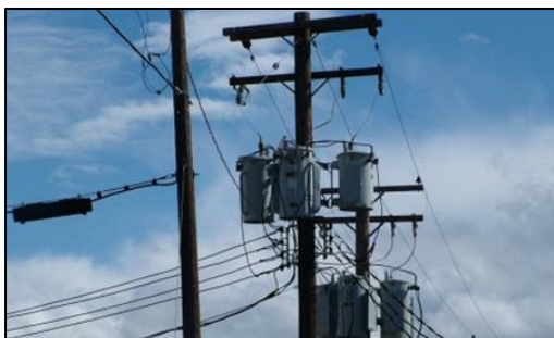
Poste de madera con transformadores
