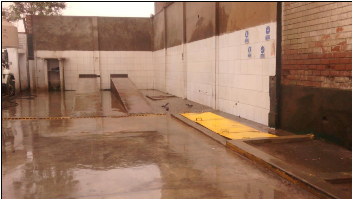
Figura 33: Vista del área de lavado y pozo séptico donde sedimenta el efluente
