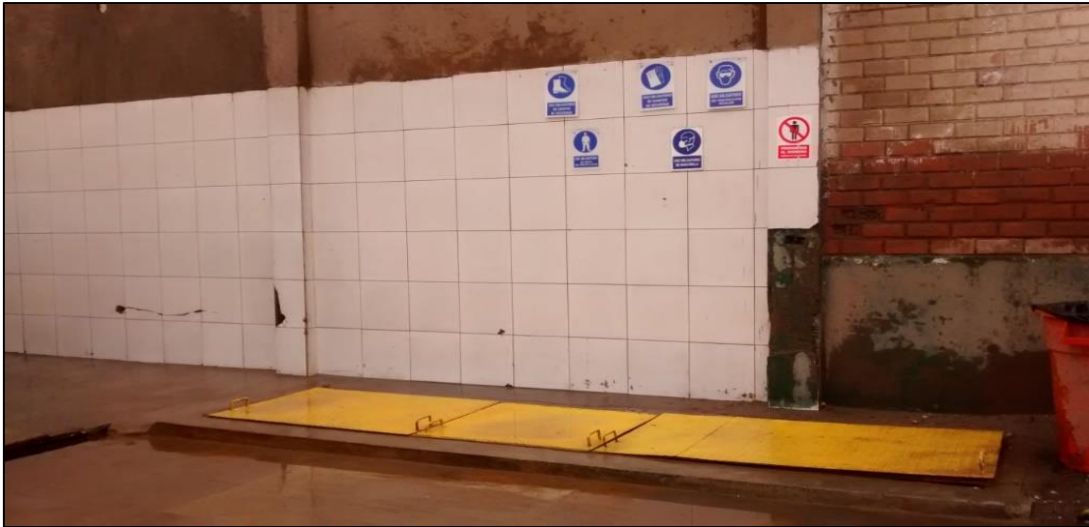
Figura 15: Pozo de séptico de Sedimentación del Área de Lavado de unidades vehiculares de la Planta de Operaciones de T.E. Prisma S.A.C.
