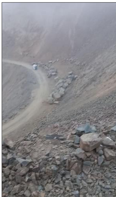
Fotografía 23. Caída de rocas y tierra, se encuentra alrededor de una vía de acceso sin asfaltar, propensa de afectar a personas o vehículos que circulan por la zona.
