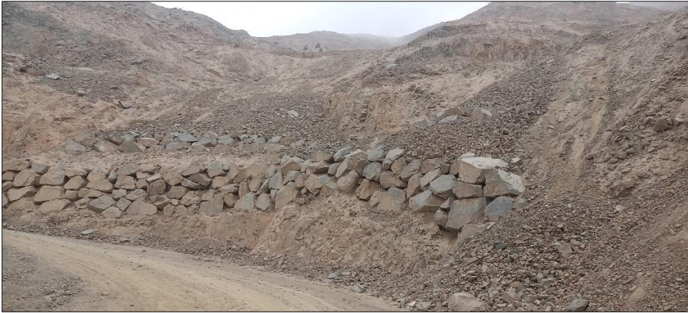
Fotografía 13. Pircado construido al lado de una vía de acceso sin asfaltar.
