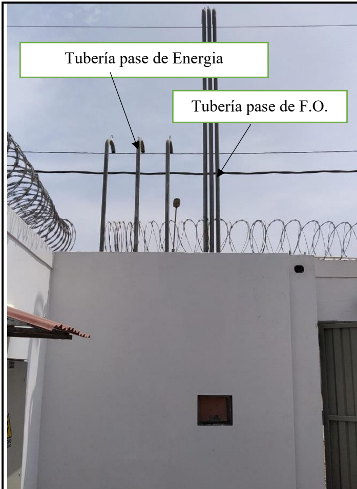
Descripción: Pase de Fibra Óptica en pared
