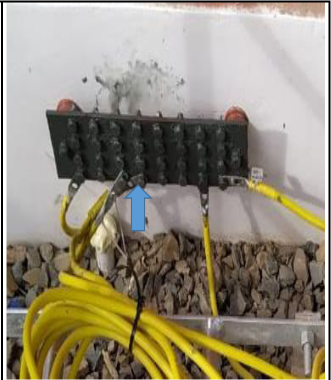
Descripción: Barra de Aterrado a Escalerillas
