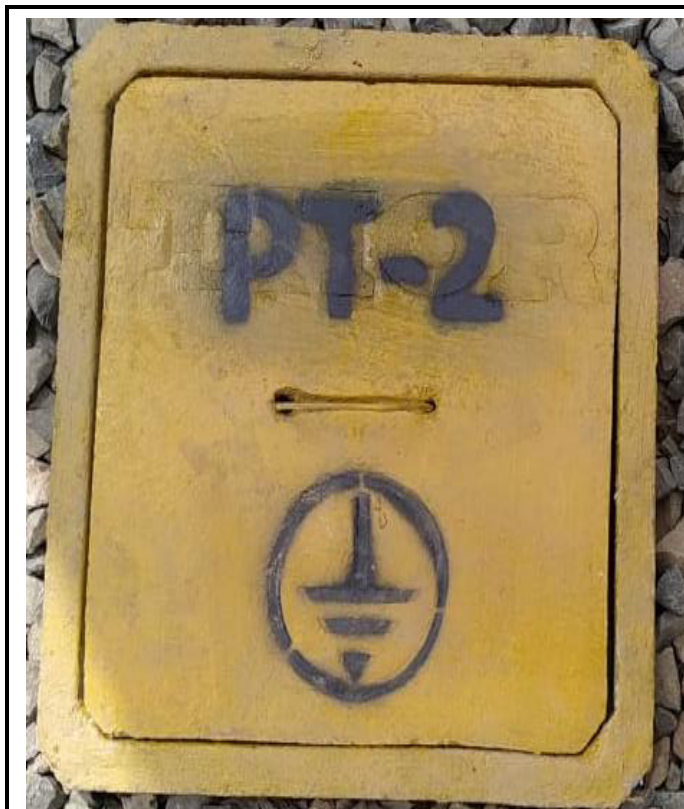
Descripción: Pozo a Tierra 2
