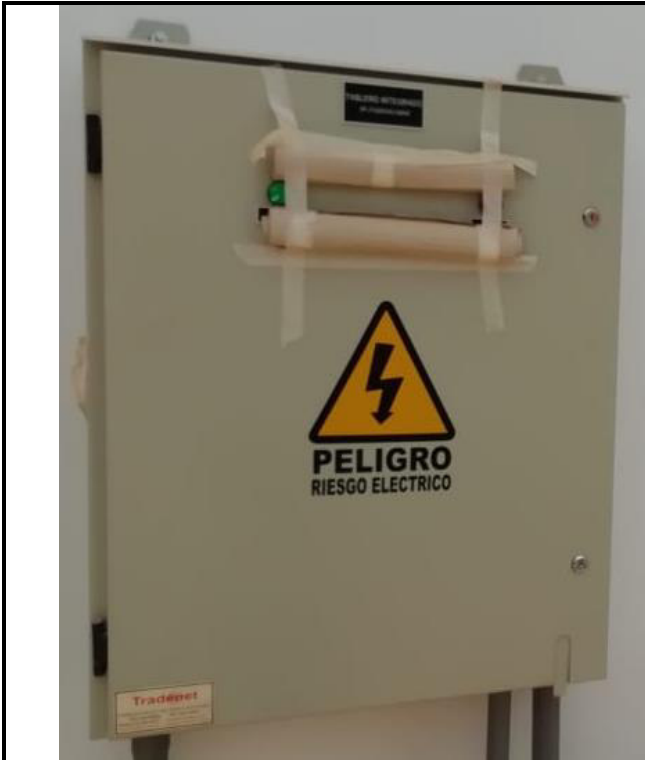
Descripción: Tablero General Cerrado
