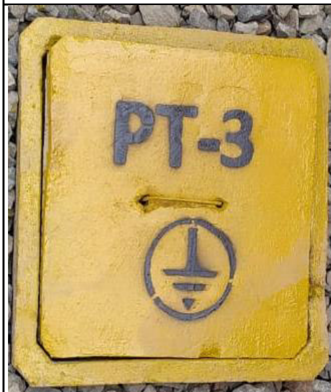
Descripción: Pozo a Tierra 3
