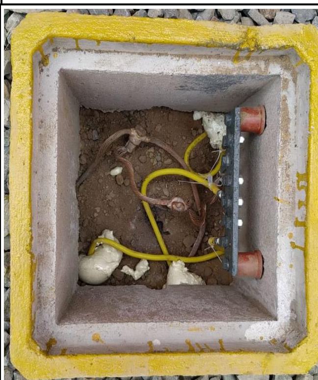
Descripción: Pozo a Tierra 3 por dentro.
