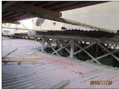
Ilustración 17: Las coberturas de las estructuras livianas no cumplen las características de pendiente y calidad (presencia de spots de agua en los techos de torta de barro existente) Fuente: Archivo fotográfico del Estudio
