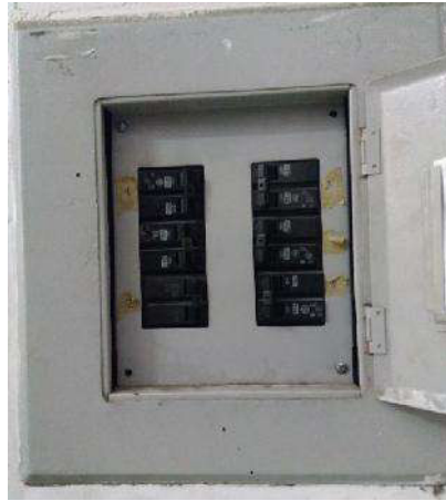
Ilustración 24: Tablero de distribución Fuente: Archivo fotográfico del estudio
