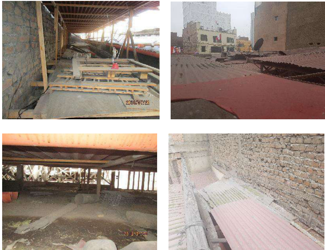
Ilustración 7: Vista de protección de techos con planchas onduladas de PVC Fuente: Archivo fotográfico del Estudio
