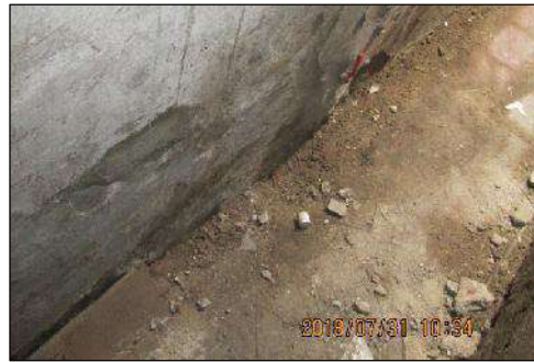
Ilustración 19: Las losas y veredas internas no presentan las características de drenaje pluvial para el buen funcionamiento y mantenimiento de los muros de adobe. (concentración de humedales)
