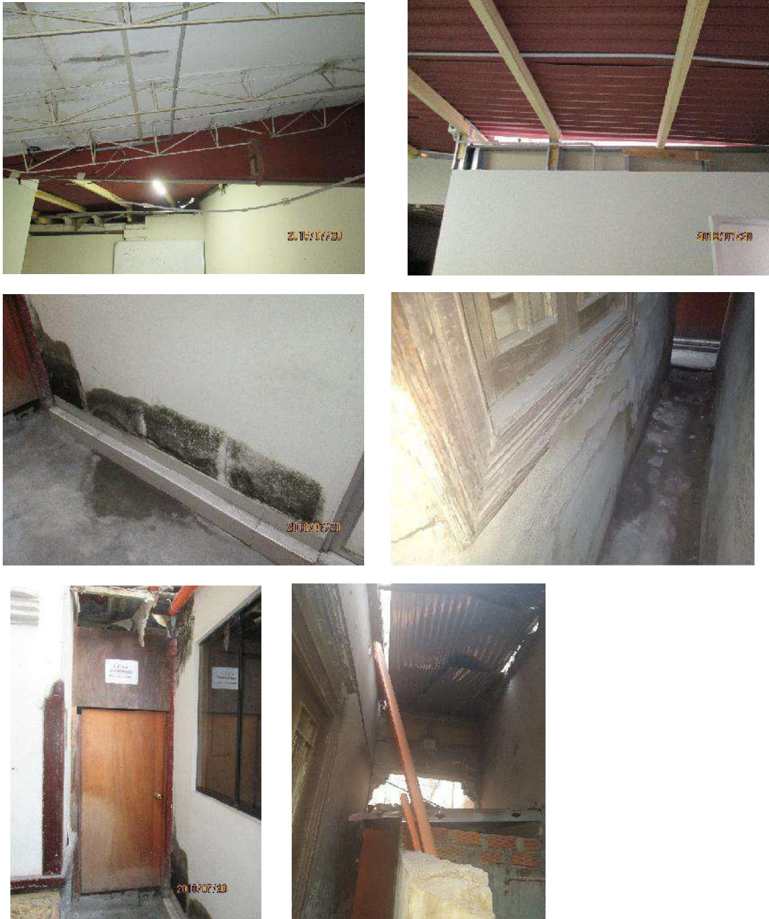
Ilustración 22: Imágenes que ejemplifican condición de Sistema Sanitario de Drenaje Pluvial Fuente: Archivo fotográfico del Estudio de Diagnóstico.
