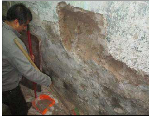
Ilustración 16: Auscultación de los muros de adobe de la edificación (Ausencia de refuerzo horizontal y vertical) Fuente: Archivo fotográfico del Estudio
