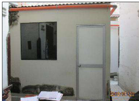
Ilustración 18: Falta de protección a los muros de drywall y adobe (muros con exceso de humedad sin la posibilidad de eliminar el exceso de agua y muros de drywall con presencia de moho) Fuente: Archivo fotográfico del Estudio
