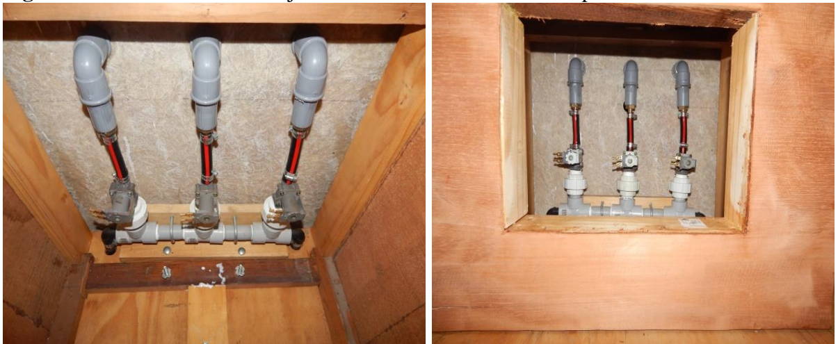
Figura 3.2.1.3.d. Vistas del conjunto de Válvulas de Solenoides para el aire.
