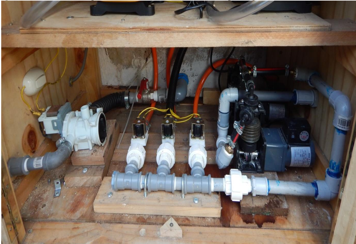
Figura 3.2.1.3.f. Vista que muestra las dos Electrobombas para aguas crudas.
