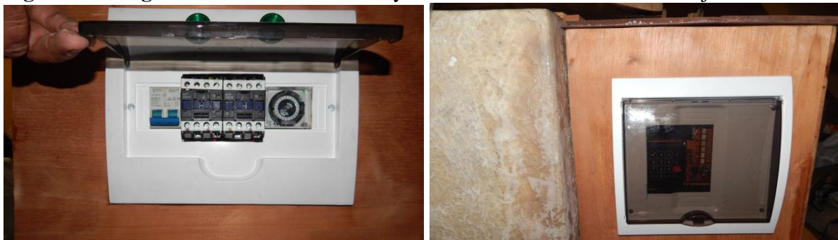
Figura 3.2.1.3.g. Vista de tablero eléctrico y del tablero donde se ubica la Tarjeta de Control.
