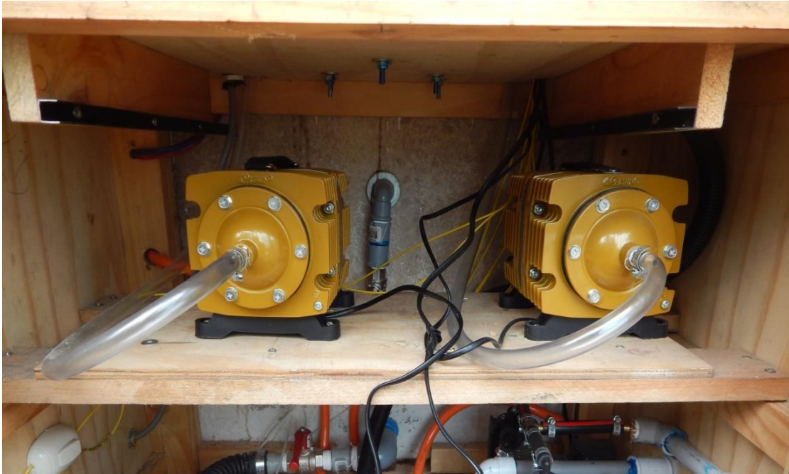
Figura 3.2.1.3.e. Vista de los dos Sopladores Electromagnéticos.
