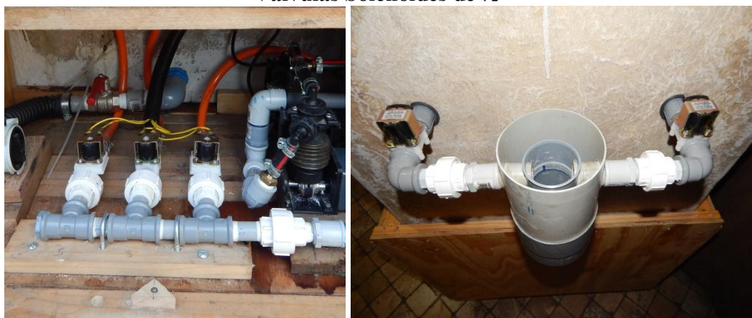
Figura 2.2.5.1. Válvulas Solenoides de ½”
