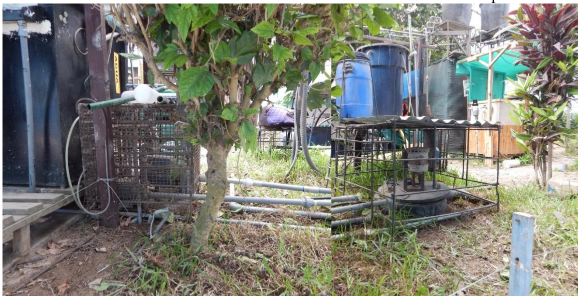
Figura 3.2.3.d. Vista compuesta de la proyección del Sistema de Riego de la FIARN, como luce actualmente conectado al Sistema de Tratamiento Compacto.
