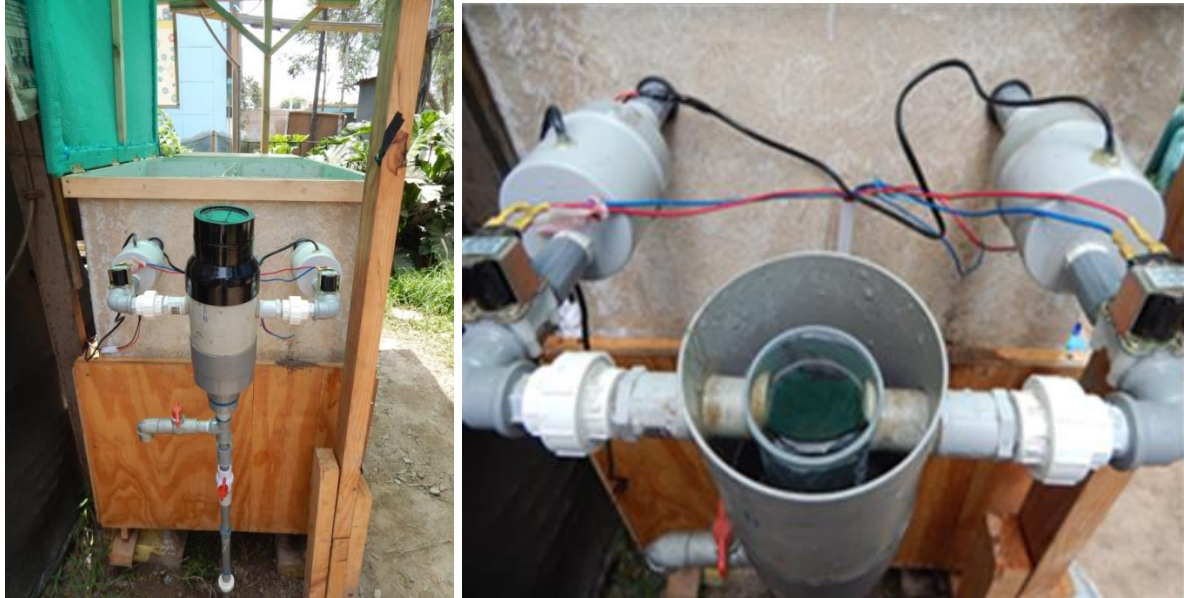
Figura 3.2.1.3.k. Vistas de las valvulas de salida del efluente tratado.
