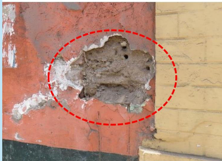
2.1. Desprendimiento de revoque. En la imagen se puede observar el desprendimiento de revoque dejando ver los adobes en la fachada del Jr. Anchash.
