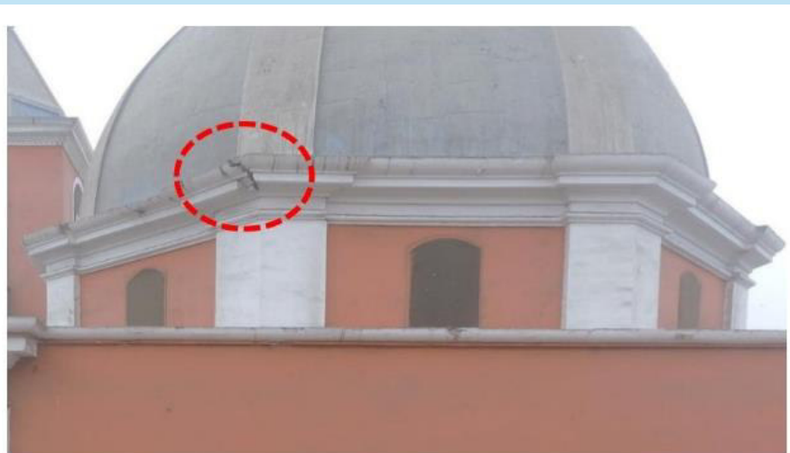
2.1. Grietas. En la cornisa de la cúpula de la Iglesia de la Buena Muerte.
