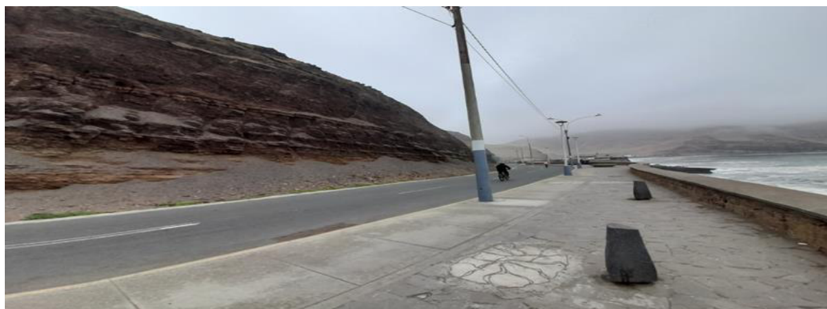
Foto No 11 (Mirando al Sur). Véase el talud de corte casi vertical, conformado por estratos de limolitas sueltas y que se acumulan en la base. Potencial caído de rocas del tipo planar
