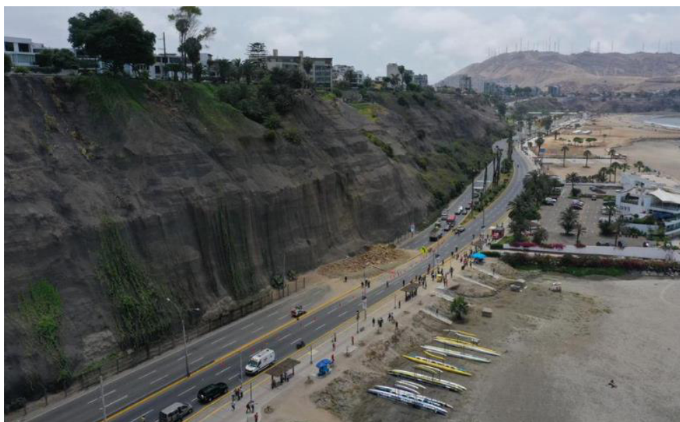
Foto No 6 (Mirando al Sureste). El mismo derrumbe de la foto anterior. Ver las cárcavas y el área ganada al mar.
