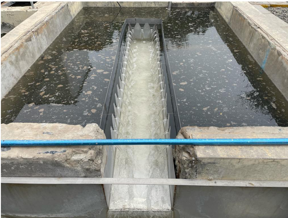
Clarificador tipo Lamellas
