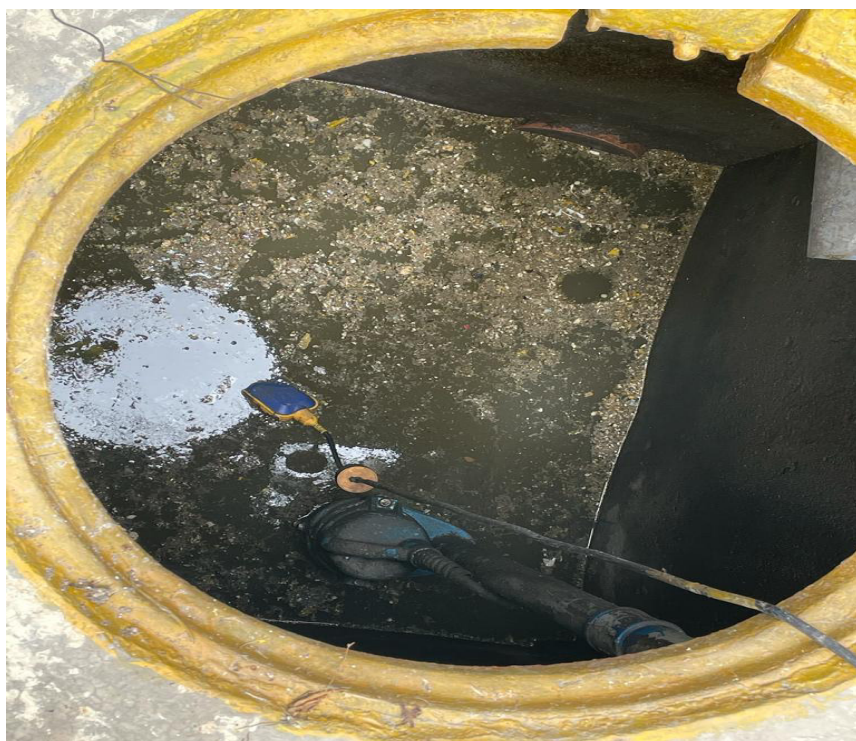
Cámara de bombeo de aguas provenientes de la Red Pública
