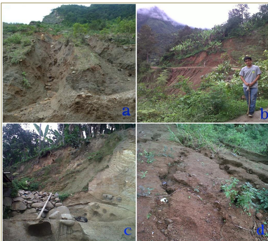
Fotografía 02: (a, b, d) Erosión hídrica en surcos y cárcavas en la localidad de Los Potreros, provocado por la acción erosiva de lluvias. (c) Alto riesgo de desprendimiento de talud debido a ampliación de terrenos.
