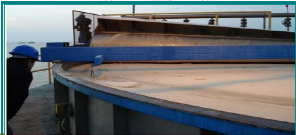
Figura N° 19: Tanque de Flotación Química
