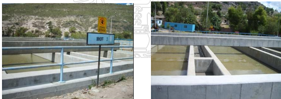
Figura 4.16 Tanque Imhoff 3, con canaleta de entrada de aguas residuales en la cabecera y canales longitudinales de sedimentación y ventilación de biogás
