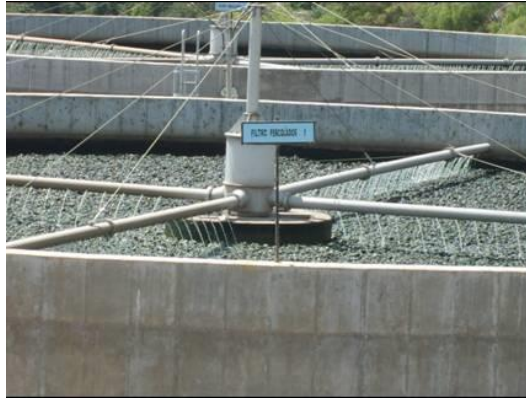
Figura 4.19 Rociador Geiger con distribuidor rotatorio en aspa instalado sobre cada filtro percolador.
