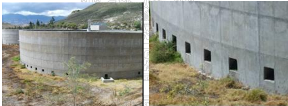
Figura 4.20 Ventanas de aireación natural instaladas en el contorno inferior del filtro percolador.
