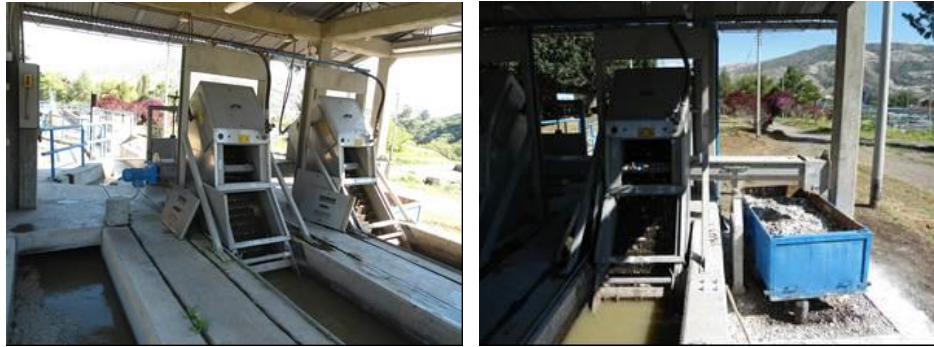
Figura 4.5 Rejillas de limpieza automatizadas con máquinas Huber, con tornillo transportador para evacuar los sólidos.
