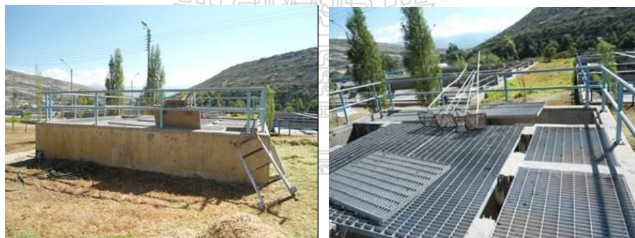
Figura 4.10 Cámara de distribución de aguas residuales, que alimentan a los tanques Imhoff.
