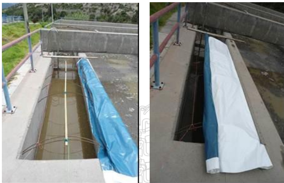
Figura 4.52 Instalación de la estructura de soporte metálico sobre el canal de ventilación y cierre con manto triple de polietileno.
