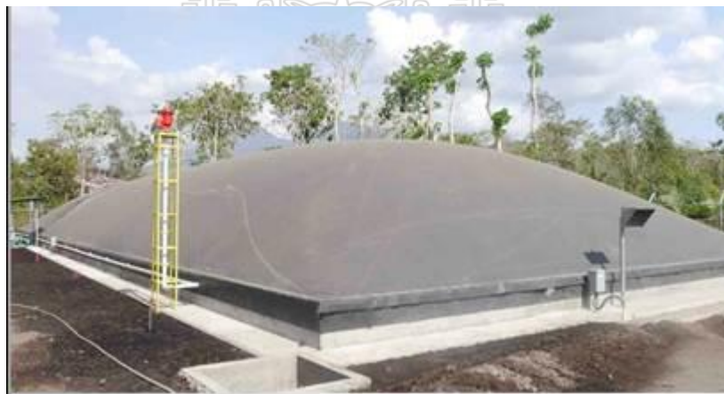
Figura 5.9 Cierre hermético de un biodigestor anaeróbico con cubierta flexible de AQFlex (Aqua Limpia Engineering)
