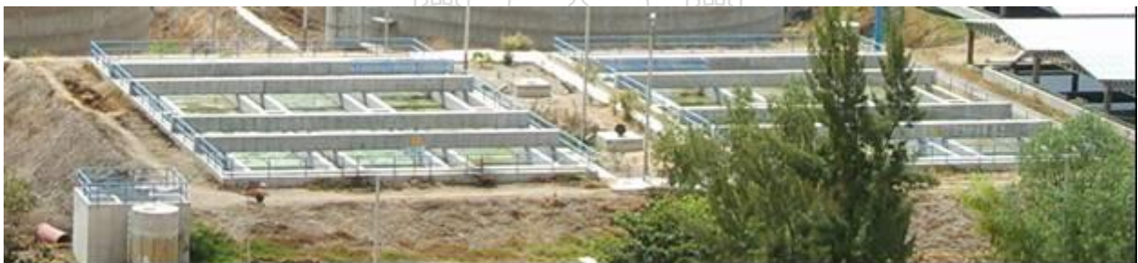
Figura 4.12 Vista panorámica de dos tanques Imhoff de la PTAR de Totorá (Imhoff 5 y 6, enumerados de derecha a izquierda).
