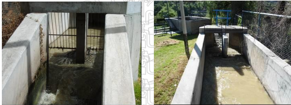
Figura 4.2 Cámara de rejas gruesas para retener sólidos gruesos acarreados por las aguas residuales.
