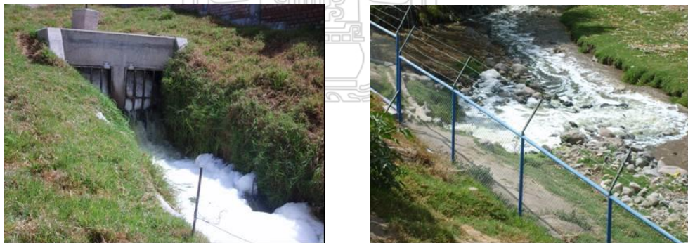
Figura 4.25 Canal disipador de energía y descarga del efluente de la PTAR de Totorá hacia el cauce del río Alameda.
