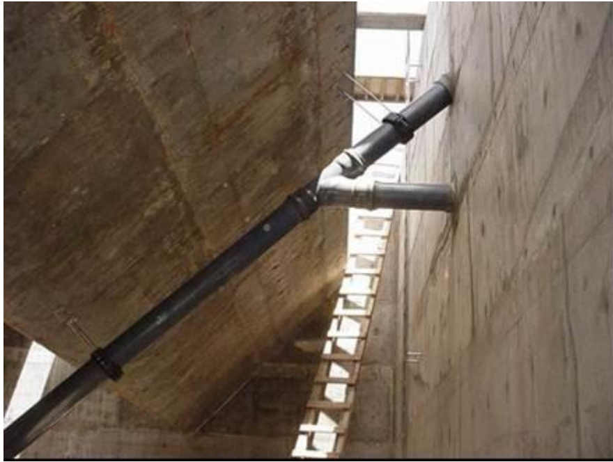
Fotografía 09 : Tubería de descarga de lodos del tanque Imhoff
