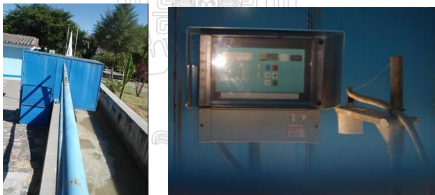
Figura 4.8 Medidor de caudal ultrasónico KAFAGUI instalado en el canal colector de aguas servidas luego del desarenado.
