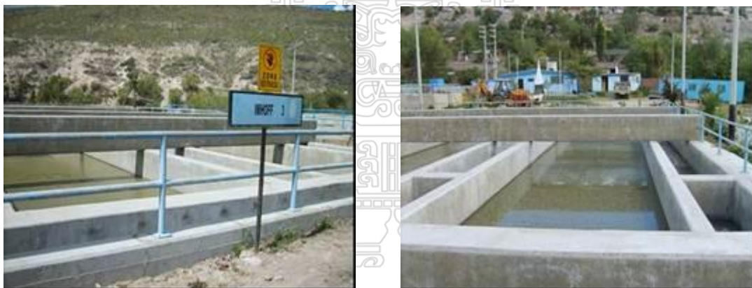
Figura 1.2 Biodigestores Imhoff de la PTAR de Totora, Ayacucho, con canales abiertas al ambiente.
