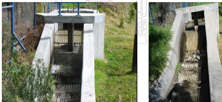
Figura 4.3 Rejillas horizontales cercanas al punto de derivación.
