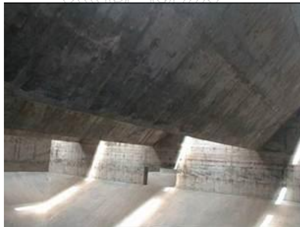
Figura 4.36 Tanque Imhoff concluida con extremo V abierta de las tres cámaras de sedimentación hacia el fondo piramidal.
