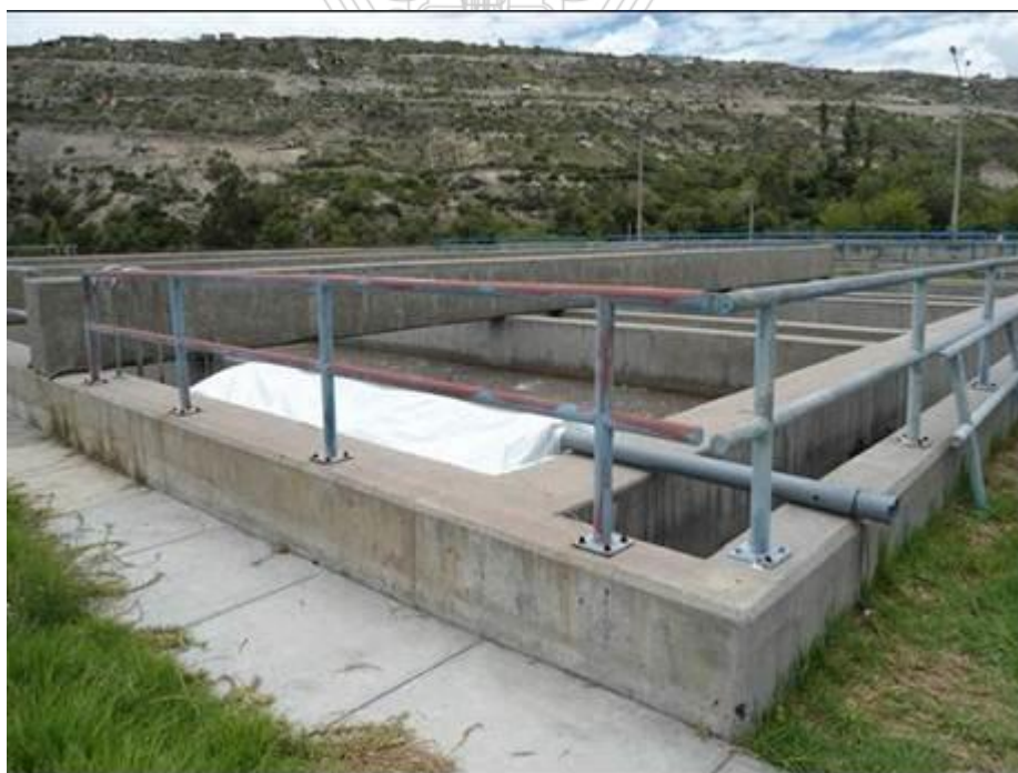
Figura 4.53 Cierre hermético del canal de ventilación con tubo emisor de biogás.
