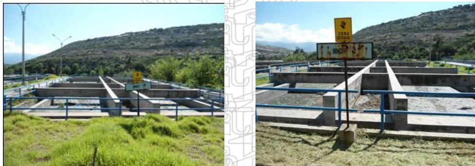
Figura 4.13 Tanques Imhoff 1 y 2, con dos cámaras de sedimentación y tres canales de venteo para emisión de biogás.
