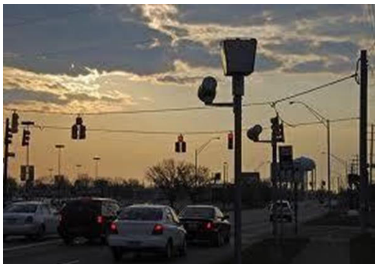
Radars con armario eléctrico
