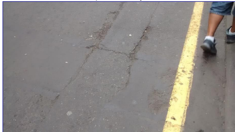
Parches continuos con diferentes niveles de severidad
