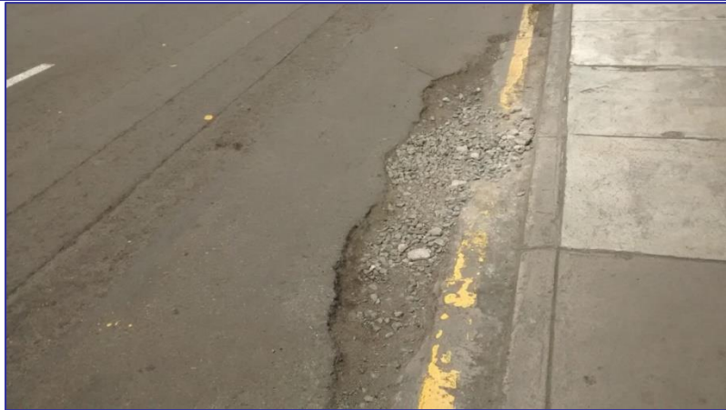
Bache producto de trabajos en vereda mal resanados
