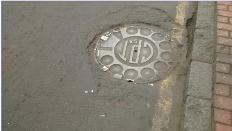
Bache producido por tapa de registro de cámara de telefonía no nivelada
