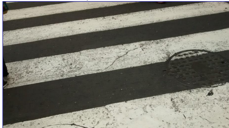
Fisuras y hundimiento en las cercanías de una cámara de telefonía
