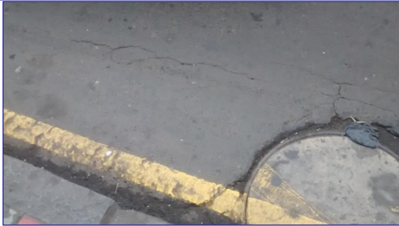
Bache y fisuras en torno a buzón de Sedapal
