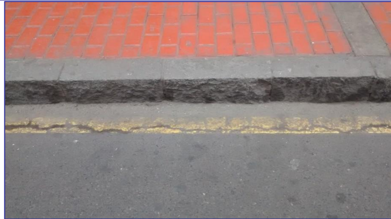
Fisura de borde sobre línea de restricción
