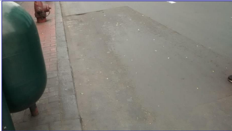
Parque colindante a hidrante, el hundimiento refleja fuga de agua
