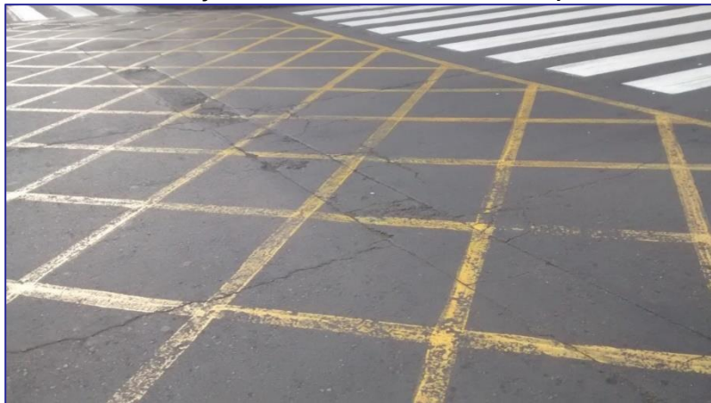
Corte en pavimento sin intervenir generando fisuras transversales y longitudinales en zona de seguridad
