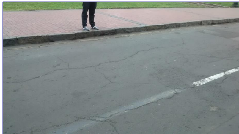
Pavimento colapsado con fisuras de múltiples características
