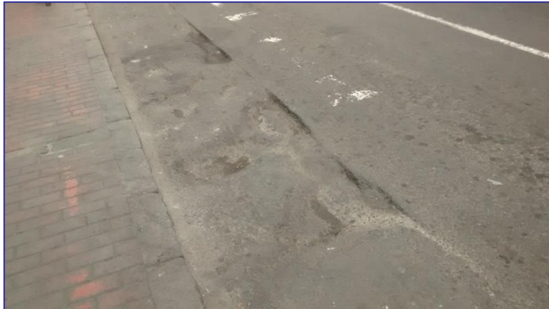
Baches internos debido a parche utilitario colapsado
