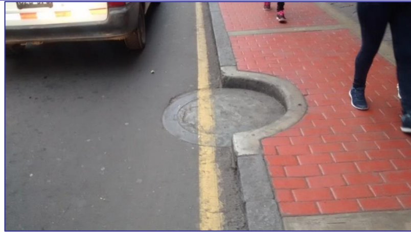
Buzón bien acabado sin generar fallas, pero se reduce el ancho de vereda
