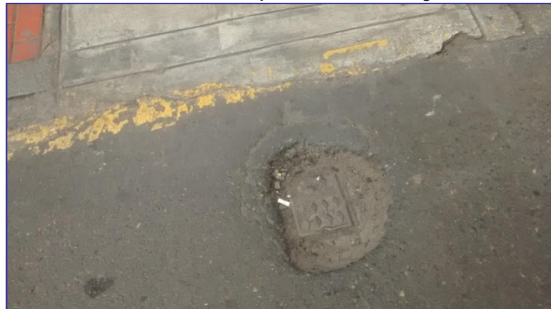
Bache producido por tapa de registro de Sedapal no nivelada
