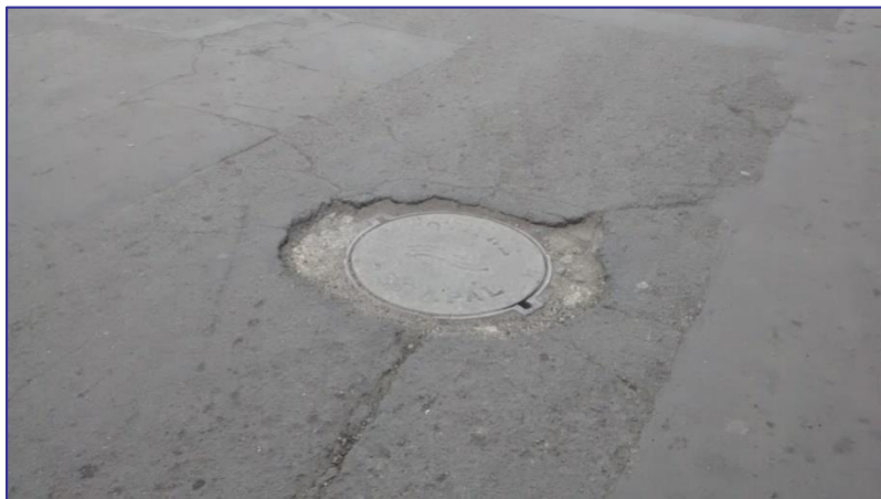
Entorno de tapa de desagüe causa bache y fisuras
