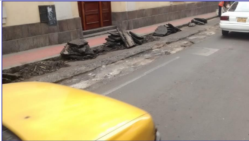
Corte en superficie de rodadura y almacenamiento de material en un costado
