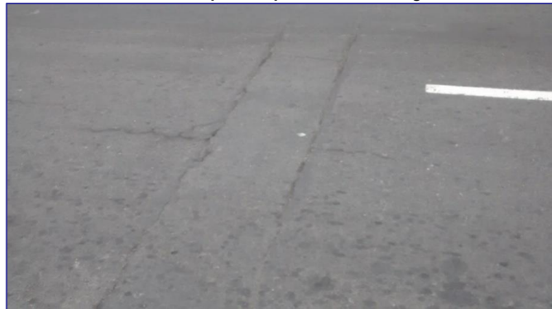
Fisuras longitudinales producidas por canalización transversal
