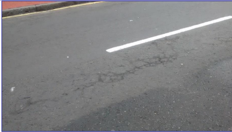
Fisuras en bloque y hundimiento en parte central de la vía
