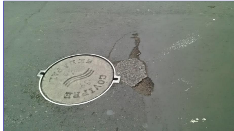
Bache colindante a tapa de buzón, nivel de severidad medio
