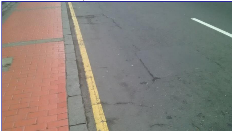
Fallas en torno a parche utilitario, se remedio la falla pero no se resolvió el problema
