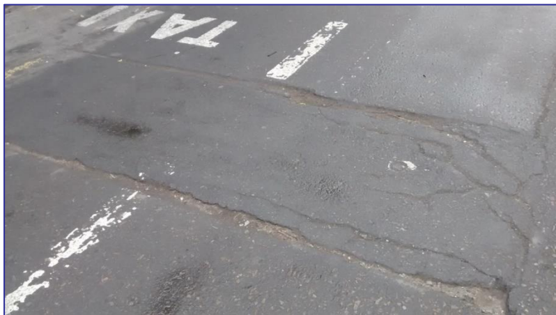
Parche colapsado con fisuras y grietas en los bordes
