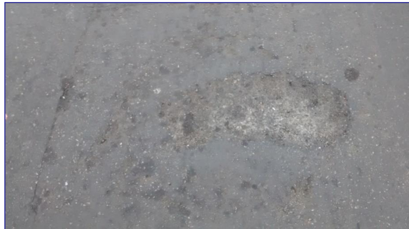
Baches y desgaste en Pavimento Jr. Ancash – Av. Abancay
