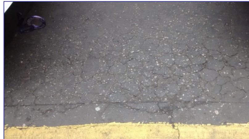
Piel de cocodrilo colindante con corte en pavimento para canalización
