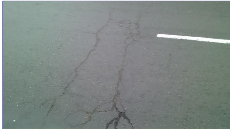
Fisuras en bloque sobre zanja con filtración
