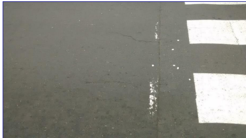
Parques y cortes utilitarios + fisuras transversales exteriores
