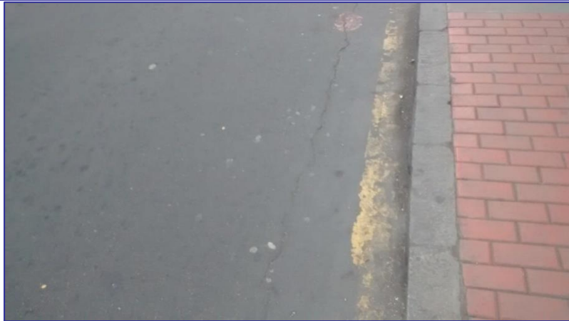
Fisura longitudinal y fisura de borde, niveles de severidad bajo
