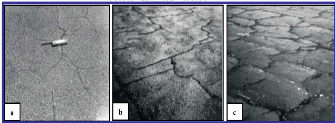
Figura 10: Fisuras en bloque
