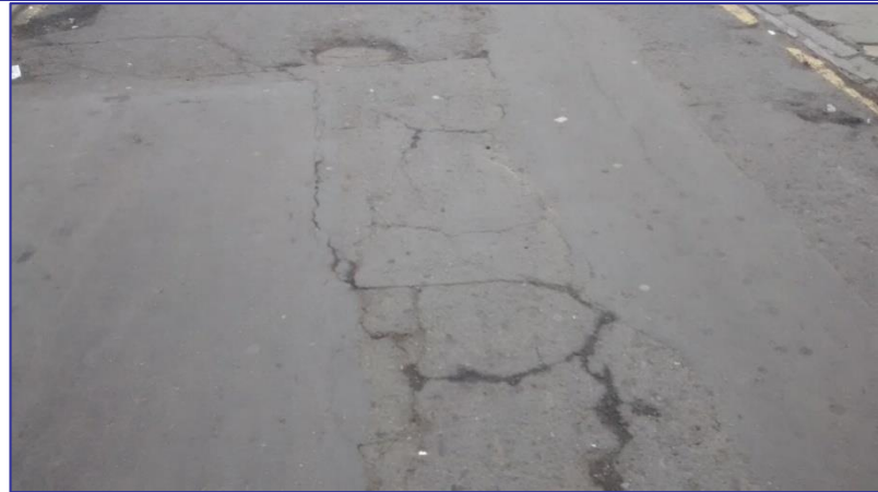
Fisuras en bloque por notable mal estado de zanja de desagüe
