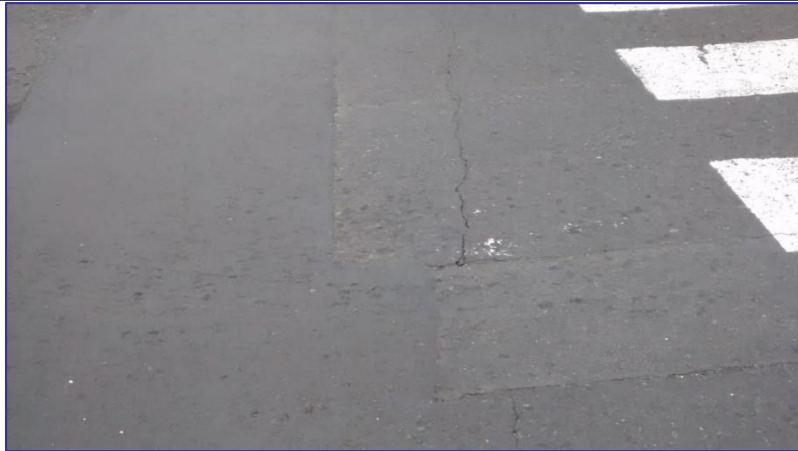
Convergencia de parches de cortes utilitarios en intersección
