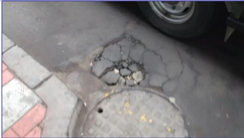
Bache por colapso de canalización mal trabajada
