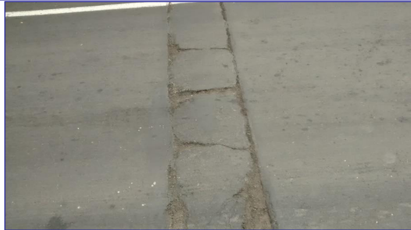
Bache, nivel de severidad medio
