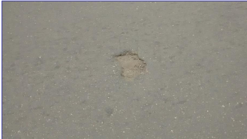
Bache, nivel de severidad bajo
