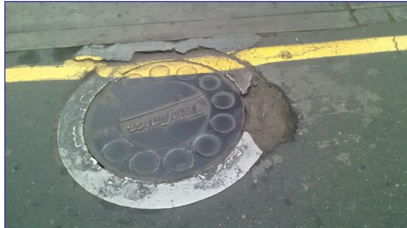
Baches en torno a tapa de cámara de Telefonía
