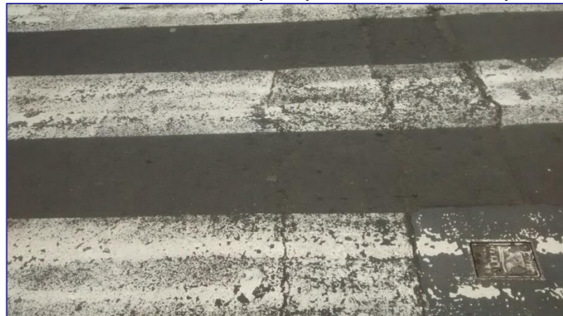
Parche y parche utilitario doble, nivel de severidad medio
