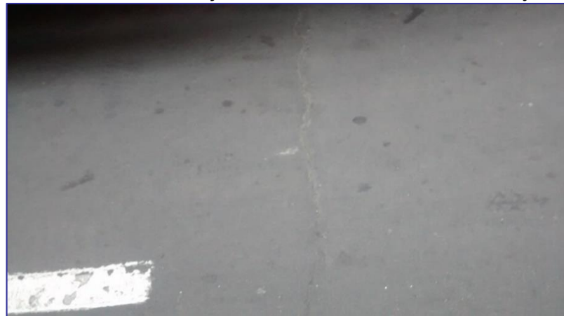
Fisura Transversal, nivel de severidad medio
