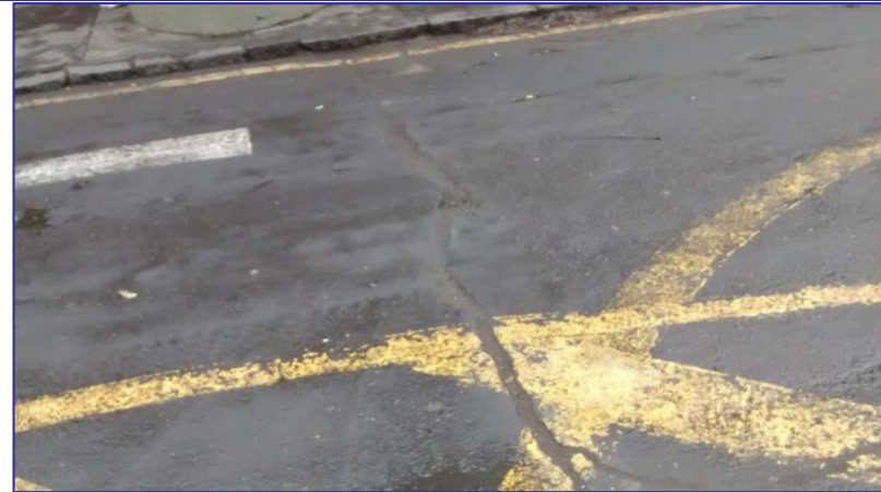
Fisura transversal con nivel de severidad alto
