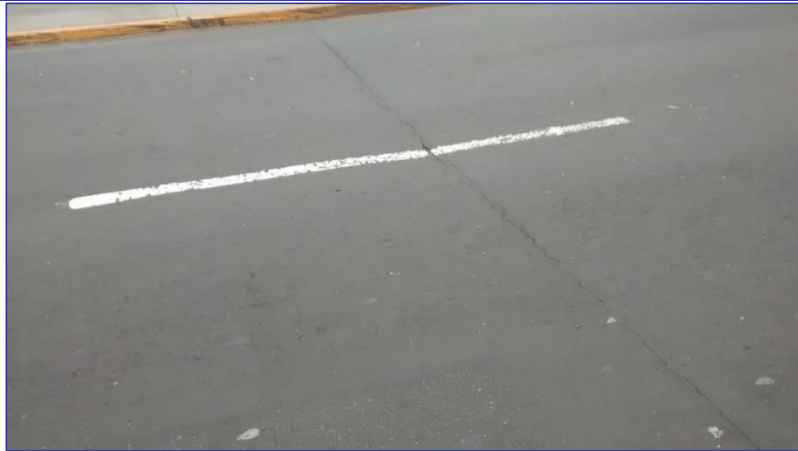
Fisura transversal, nivel de severidad medio
