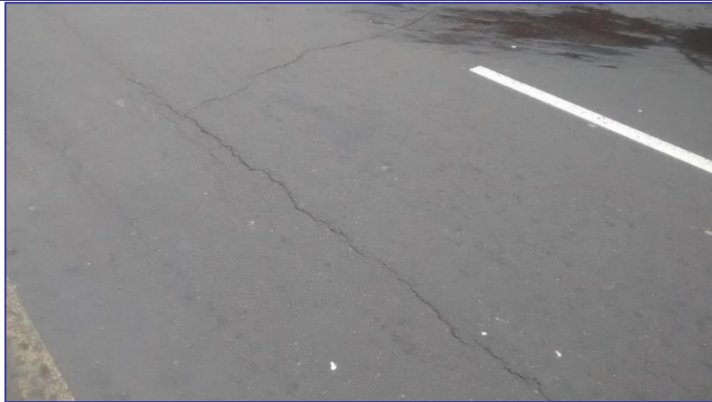
Fisura Longitudinal y transversal, nivel de severidad bajo
