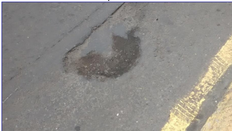
Baches con presencia de humedad en torno a canalización
