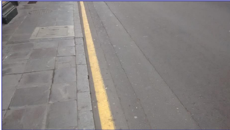
Doble canalización para servicios exponiendo a falla la parte no tratada
