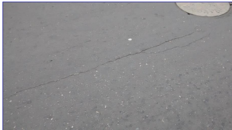
Fisuras longitudinales convergentes en buzón de Sedapal
