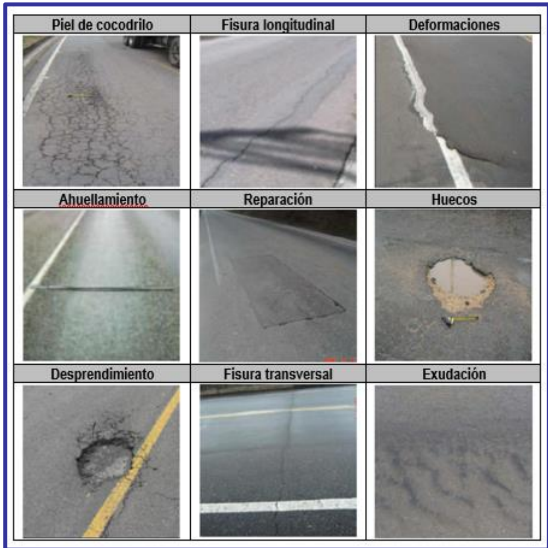
Figura 4: Daños en los pavimentos
