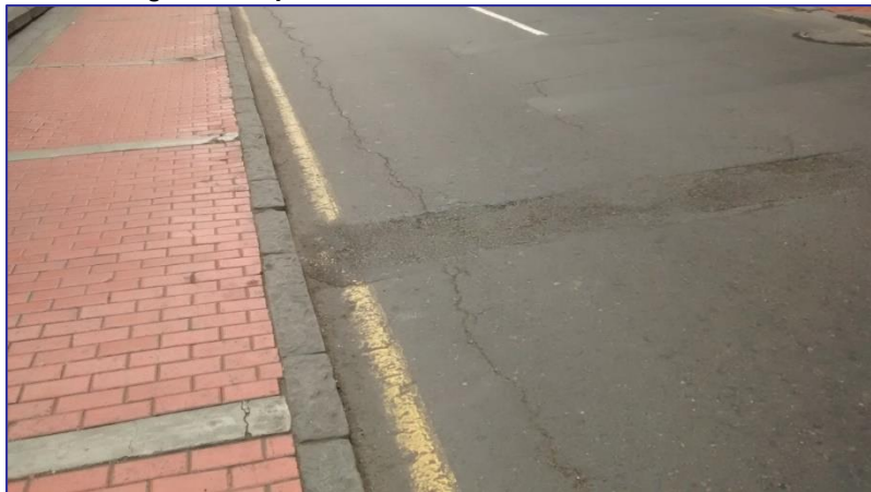
Fisura longitudinal y hundimiento transversal
