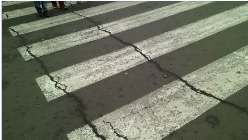
Fisuras transversales en paralelo, con nivel de severidad alto
