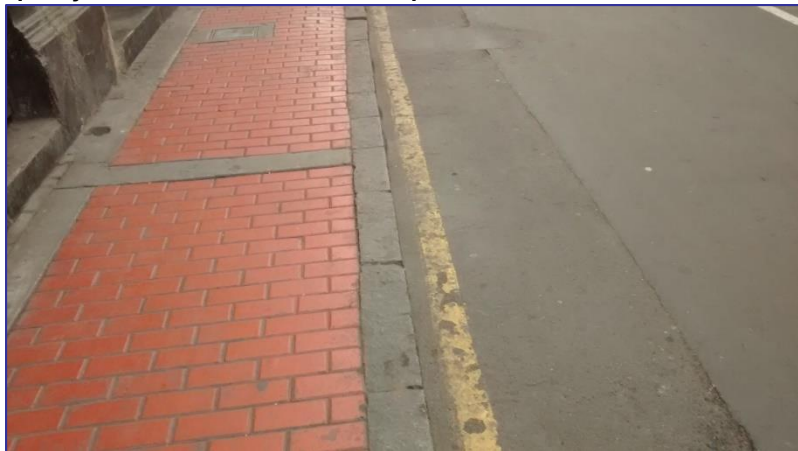
Parques y cortes utilitarios, nivel de severidad medio
