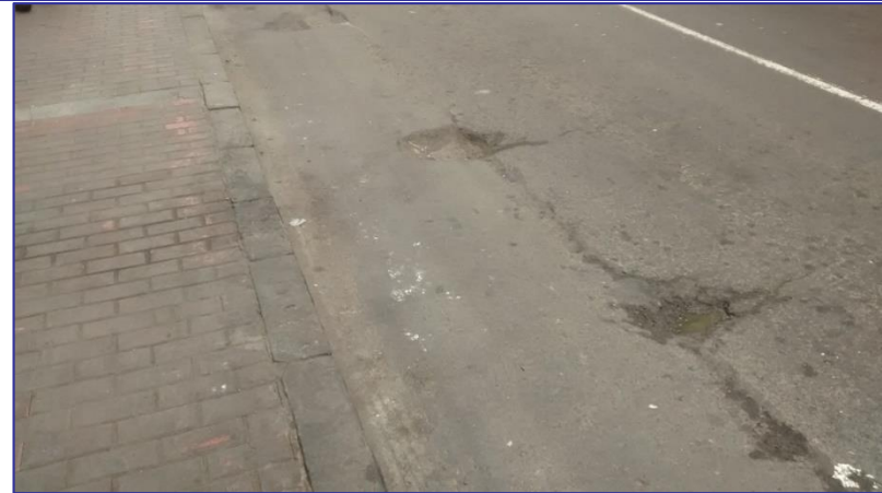
Baches colaterales a parche longitudinal de canalización
