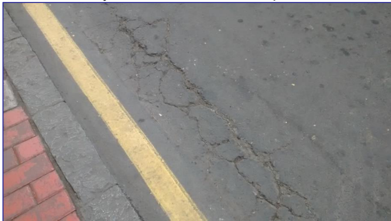
Corte longitudinal en vía, parche y fisuraciones colaterales
