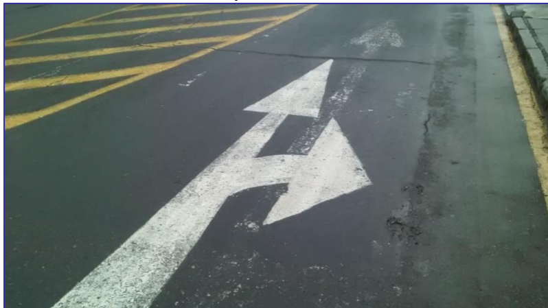
Parche utilitario longitudinal y señalización horizontal mal emplazada
