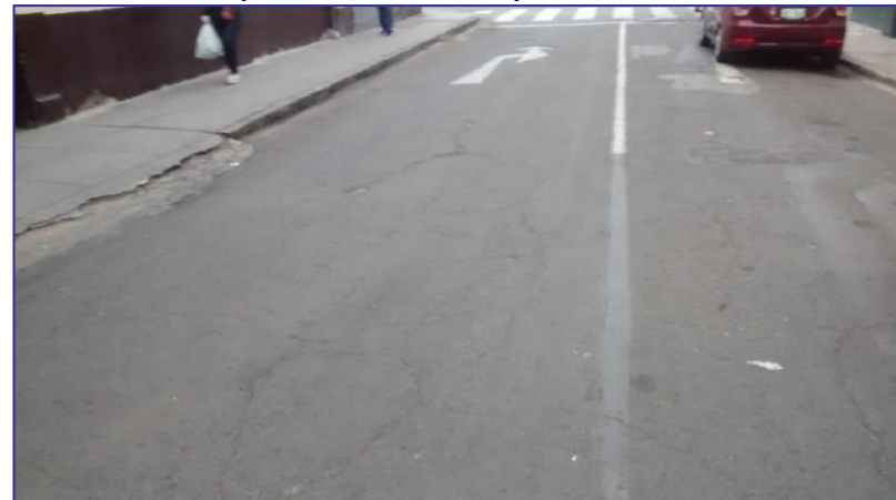
Rampa vehicular en mal estado e invadiendo carril de circulación
