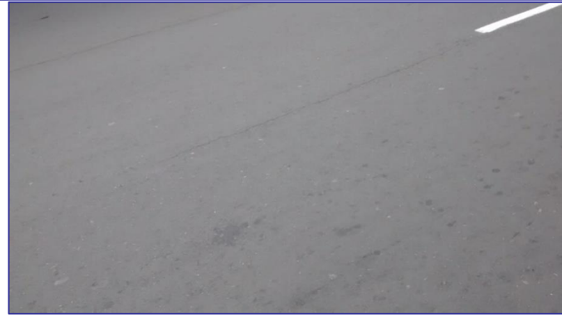
Fisuras longitudinales en paralelo, niveles de severidad bajo
