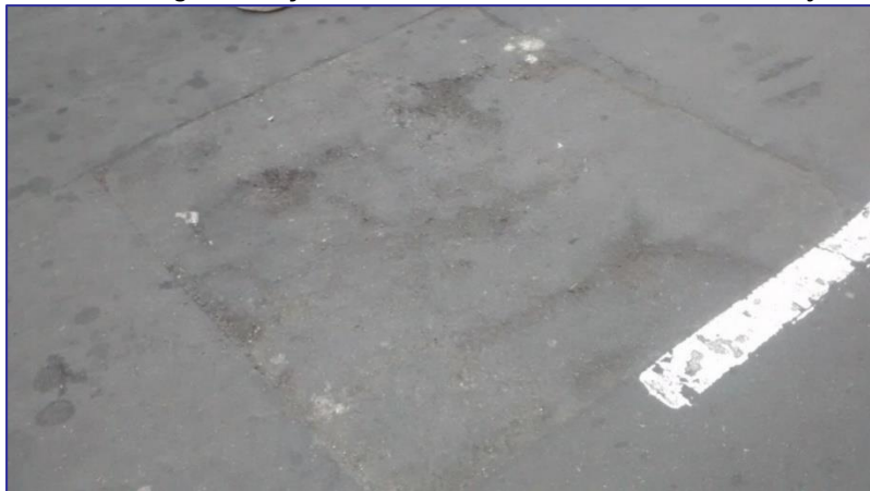
Parche y corte utilitario, nivel de severidad medio
