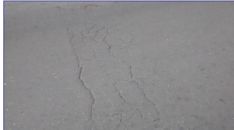
Fisuras en bloque como producto de zanja mal compactada
