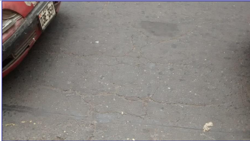
Fisuras en bloque sobre zanja
