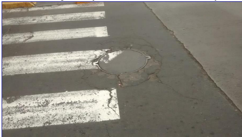
Fisuras en torno a tapa de buzón de Sedapal
