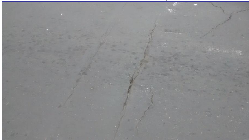
Pavimento en mal estado tramo Jr. Ancash – Av. Abancay
