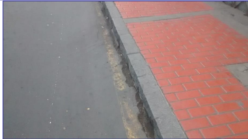
Se muestra la marcación con tinta para que se realice corte en el pavimento
