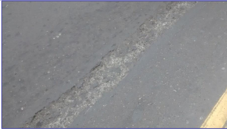
Bache, nivel de severidad medio
