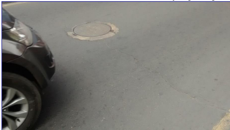
Fisura transversal converge en tapa de buzón de Sedapal
