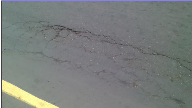
Tramo hundido con presencia de zanja mal trabajada produciendo fallas
