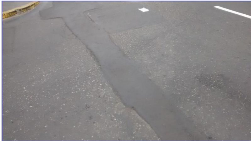
Pavimento resanado con una baja calidad
