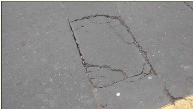
Parches y parches utilitarios con diferentes niveles de severidad
