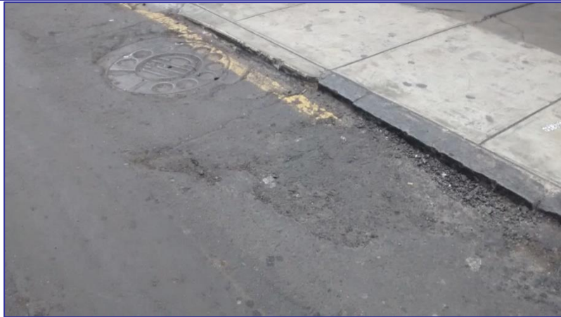
Parche colapsado colindante a tapa de antigua Compañía Peruana de Teléfonos
