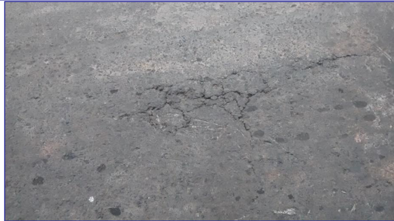
Fisuras en bloque presentes de manera natural
