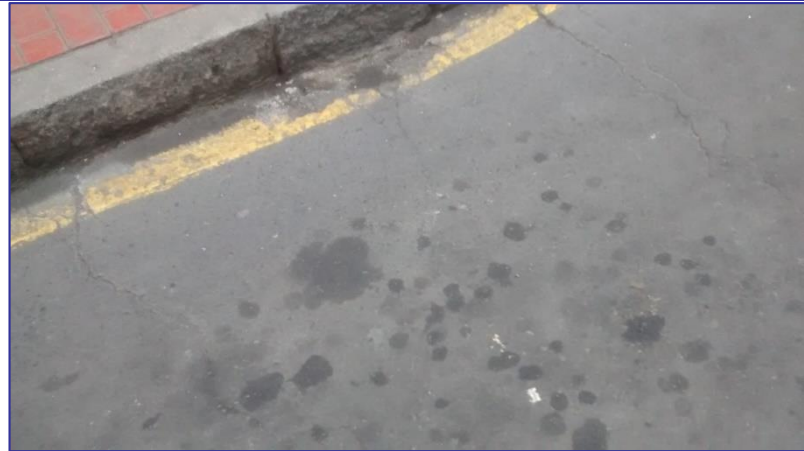
Fisuras transversales y hundimiento, niveles de severidad bajo
