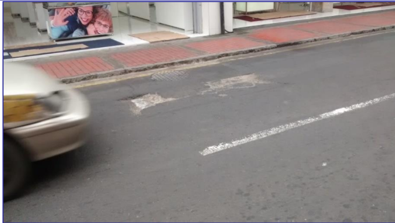
Baches alrededor de tapa de concreto de cámara de telefonía
