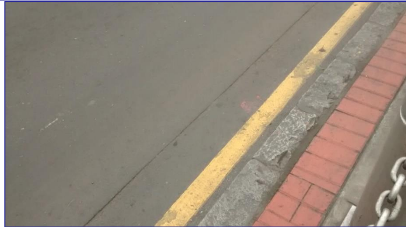
Corte en pavimento sin intervención
