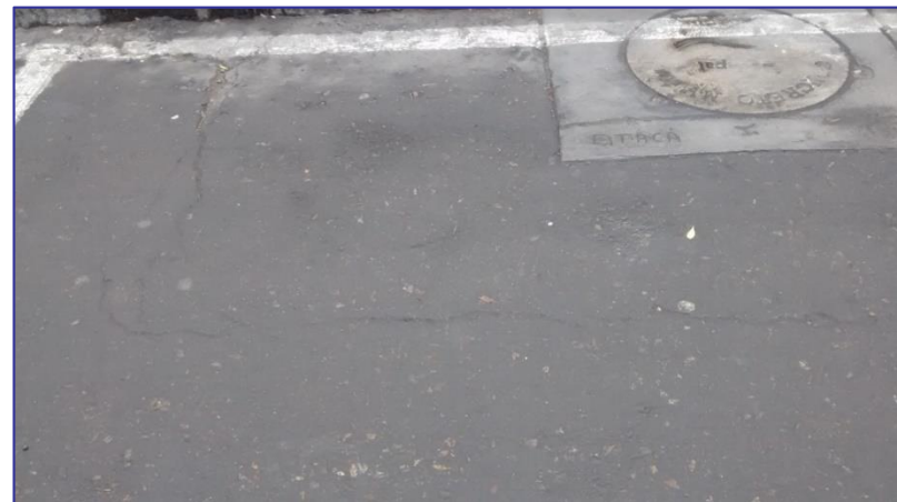
Entorno de tapa de cámara de concreto con fallas visibles y colapso en el corto plazo
