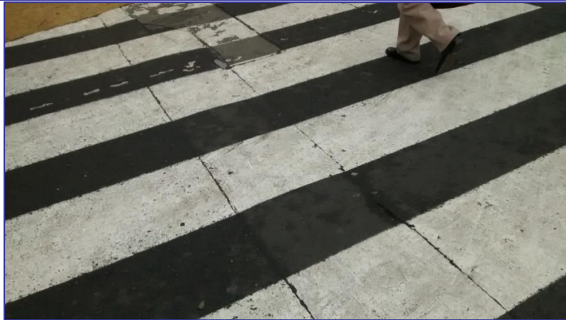
Corte para canalización no intervenido y parche con concreto en pavimento de asfalto
