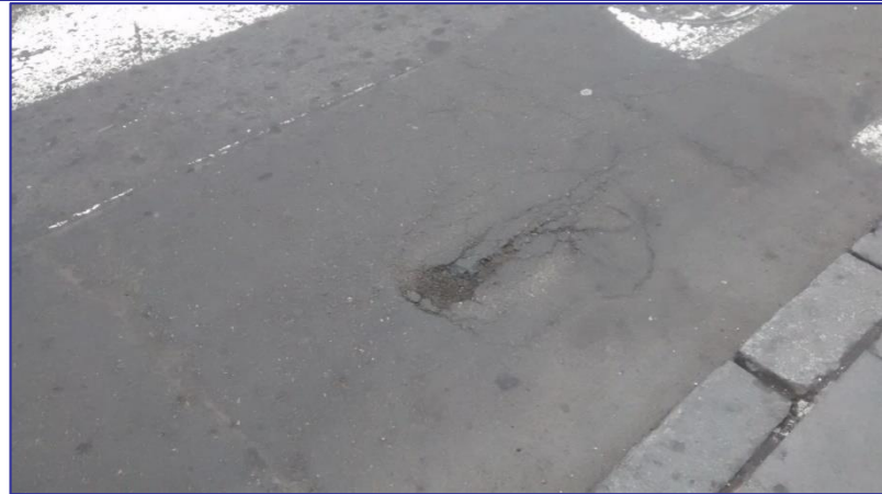
Parche colapsando por filtración de agua
