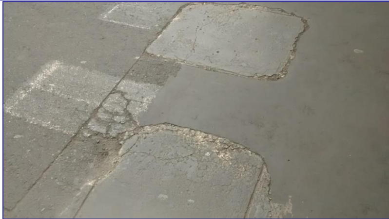
Parches y parches de cortes utilitarios, nivel de severidad medio
