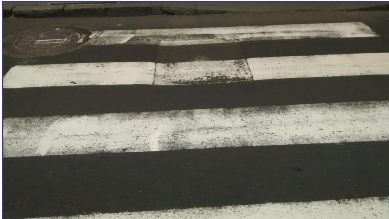
Parques y cortes utilitarios cerca de tapa telefónica, nivel de severidad bajo
