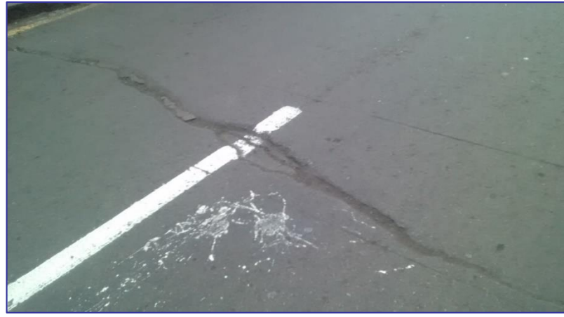
Fisura transversal, nivel de severidad alto
