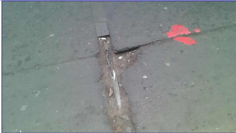
Desprendimiento de cobertura de canalización eléctrica, con cables expuestos
