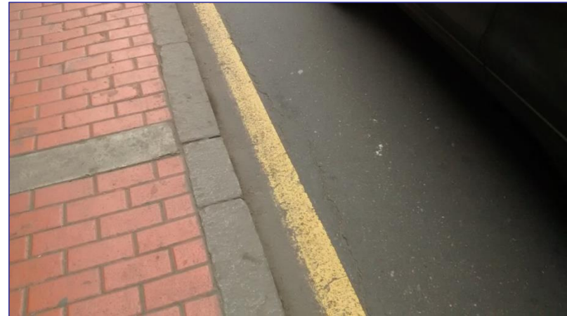
Fisura de borde, nivel de severidad bajo
