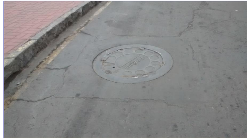
Parche colapsado colindante a tapa moderna de telefonía
