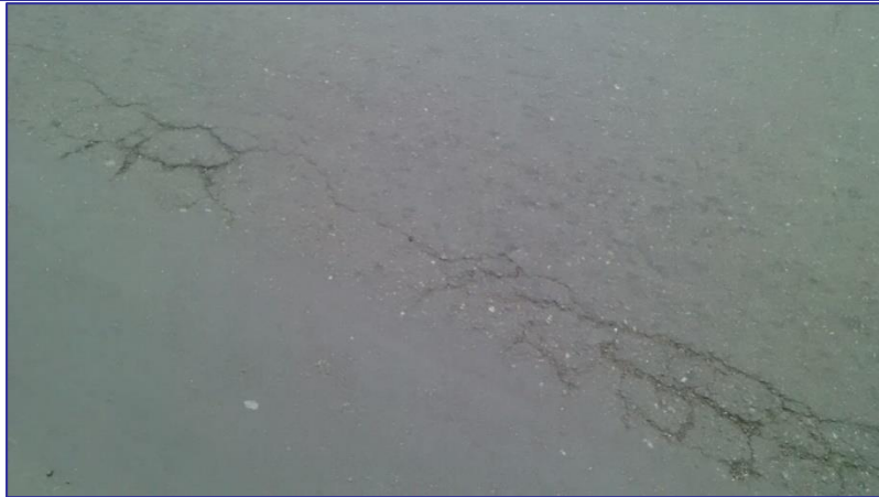
Fisuras en bloque en torno a canalización resanada
