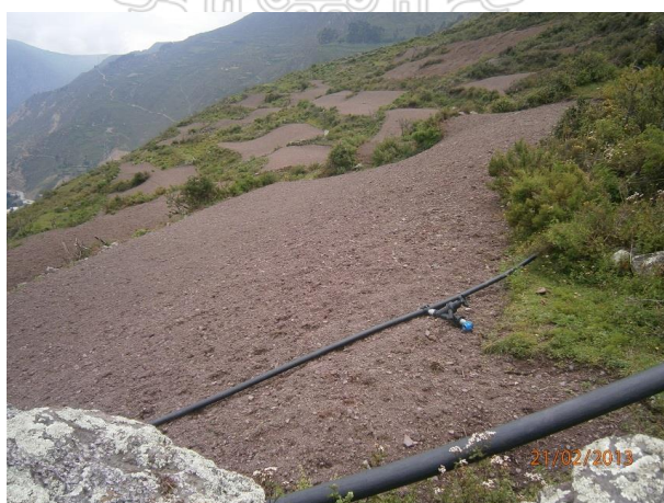
Vista de las tuberías que regarán los campos por aspersión
