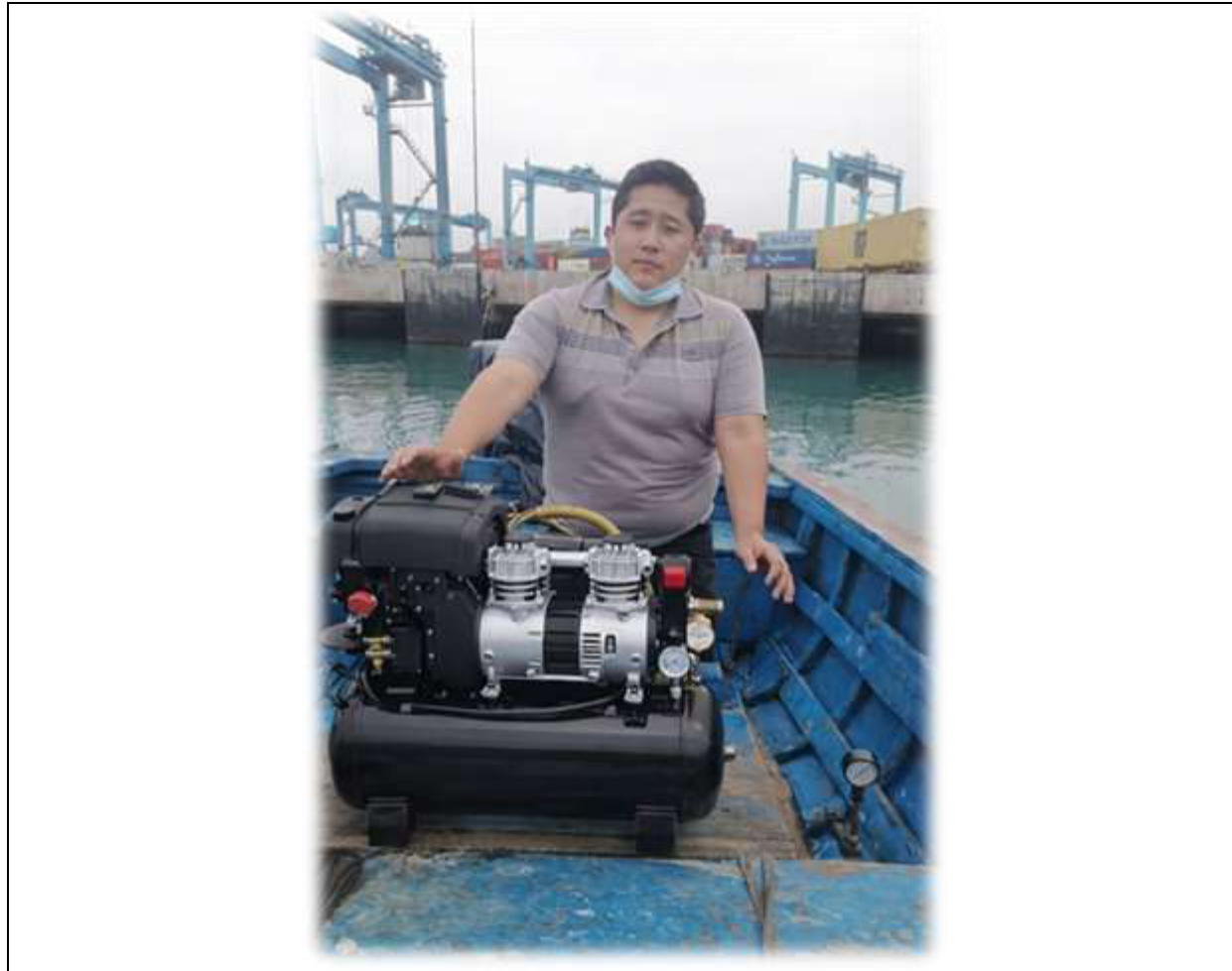
Verificación de instalación de equipos compresores por parte del ingeniero a cargo en la fase de implementación.
