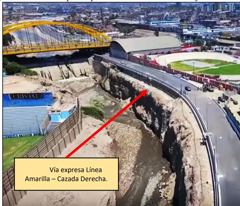
Figura 50: Pantalla de pilotes para la construcción de una vía junto al río Rímac
