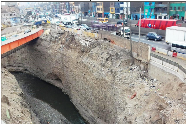
Fotografía 5 Socavamiento del talud pasada la época de avenida.
