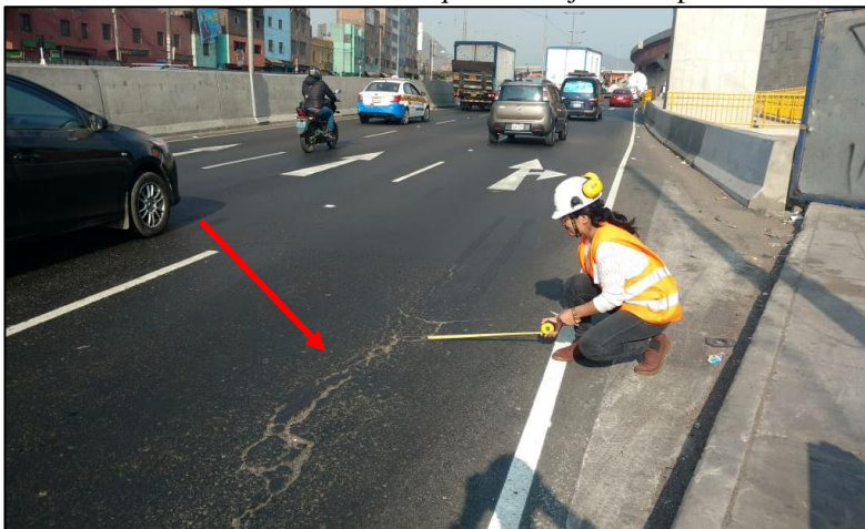
Fotografía 6 Fisuras en el hombro del talud que se reflejan en el pavimento.
