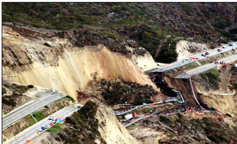
Figura 1: Deslizamiento de la carretera Tijuana y Ensenada (Baja California, México)
