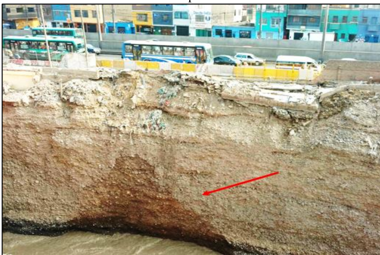
Fotografía 4 Erosión del talud durante la época de avenida del río Rímac.
