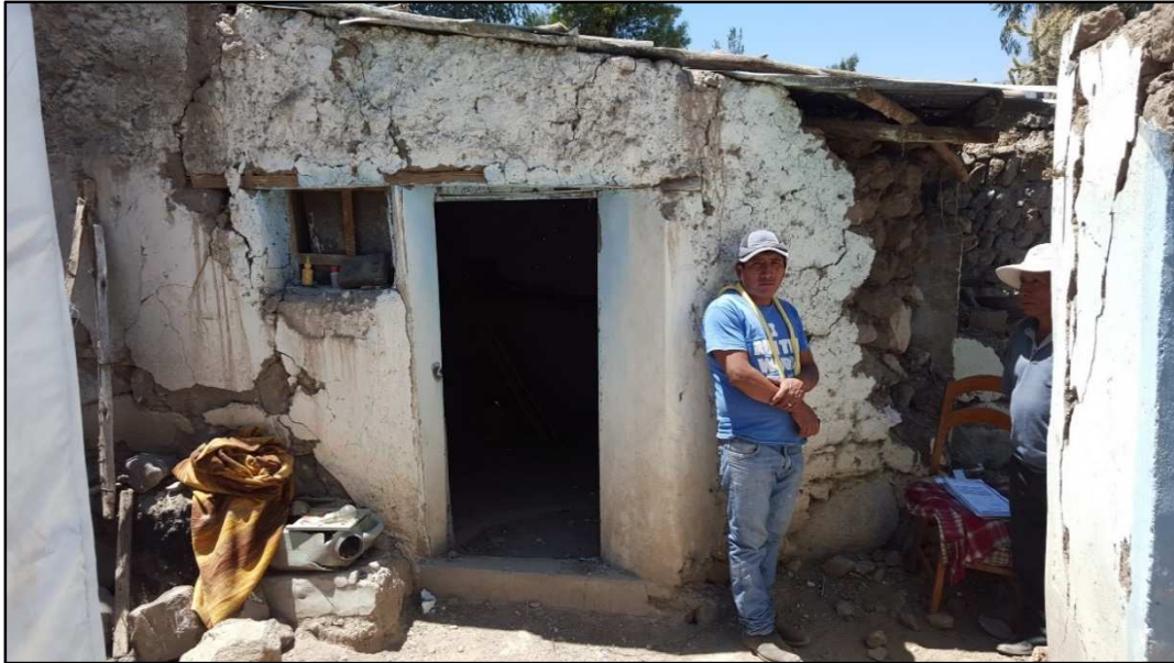
Fotografía Nro. 12 Vivienda en estado Inhabitable, Marzo 2017
