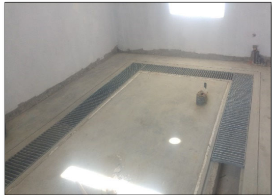
Foto de la Sala del Generador
