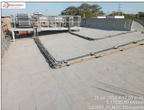
Foto de la plataforma metálica de equipos
