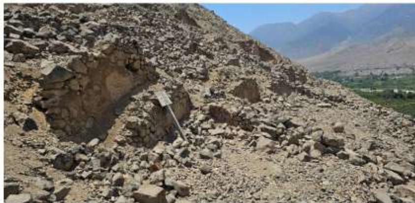
Foto N° 5. Detalle de estructuras arquitectónicas. Muros adosados a modo de contención, construido con piedra sin cantar con argamasa de barro. Asimismo, presenta una capa de barro a modo de enlucido.
