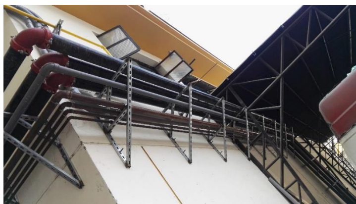
Instalaciones en los exteriores hacia la UCI
