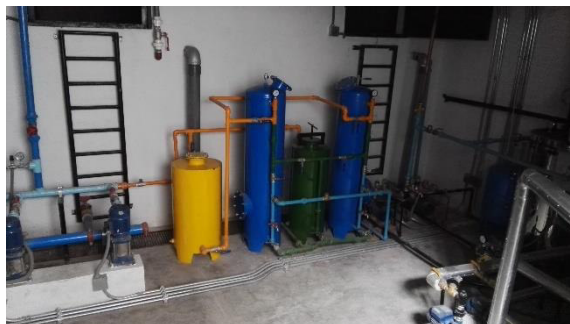
Vista de los equipos del cuarto de bombas de la cisterna
