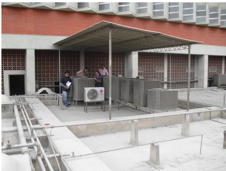
ACONDICIONAMIENTO AIRE ACONDICIONAMIENTO HOSPITAL MARIA AUXILIADORA
