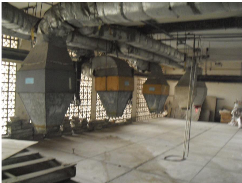
ACONDICIONAMIENTO AIRE ACONDICIONAMIENTO HOSPITAL MARIA AUXILIADORA
