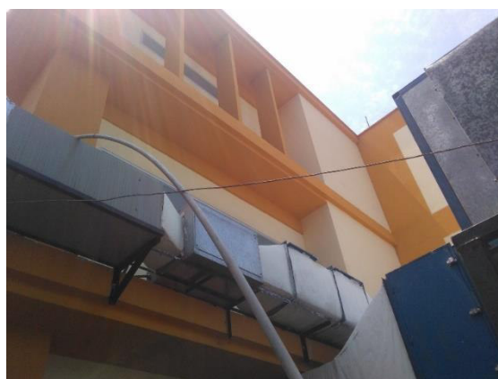
Vista de los ductos de Aire Acondicionado
