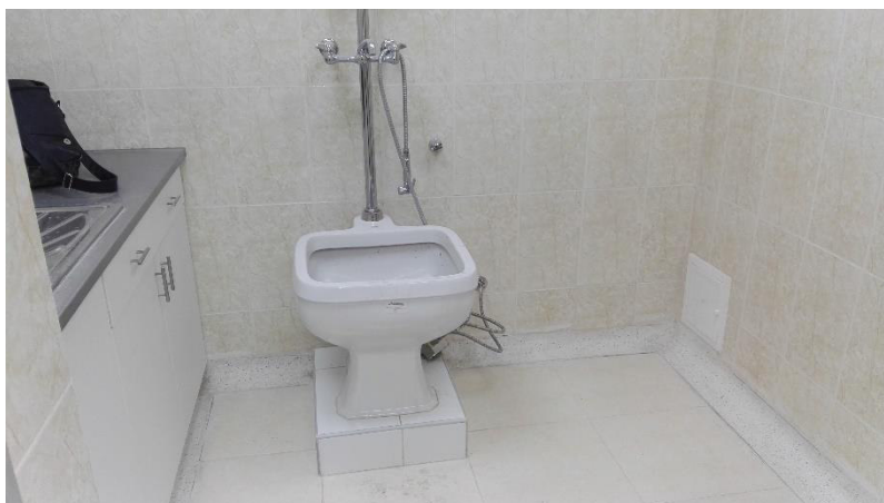
Vista del botadero clínico de loza vitrificada blanca con Fluxómetro control de pie de agua fría y caliente para lavachatas
