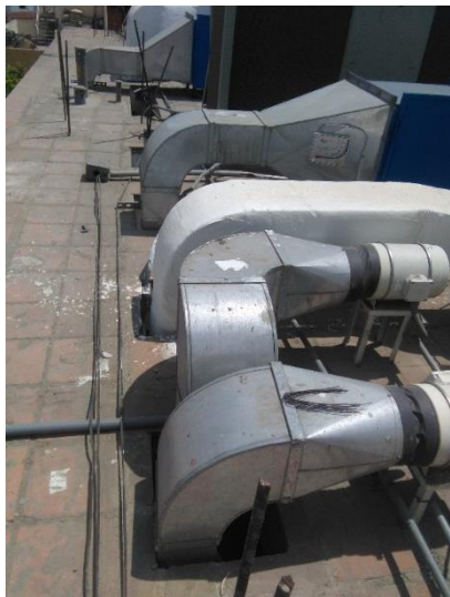
Vista de ductos de aire acondicionado en la planta de techos
