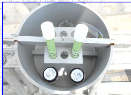
Figura N° 25 Tubos pasivos para SO 2 y NO 2 instalados en el Porta tubo.
