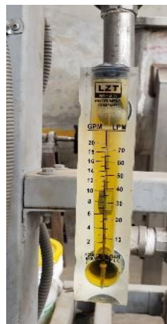
Medidor de flujo del sistema de cavitador
