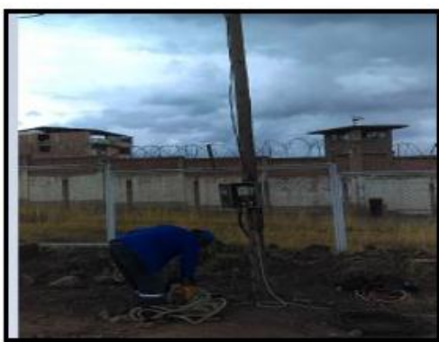
Fotografía 07: Energía eléctrica provisional
