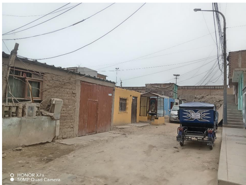
Frontis derecho de la Mz A2 muestra viviendas en pésimo estado.
