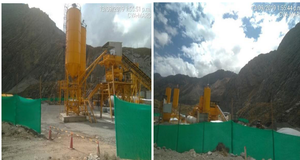
Planta de producción de concreto
