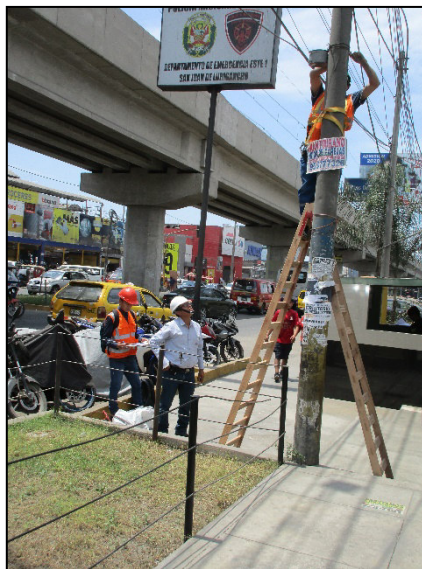
Fotografía 2. Portatubo pasivo instalado en la avenida Próceres de la Independencia.
