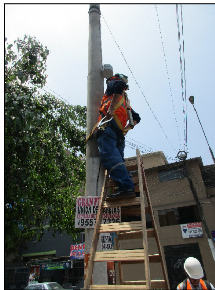
Fotografía 3. Portatubo pasivo instalado en la avenida Próceres de la Independencia.
