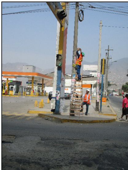
Fotografía 1. Portatubo pasivo instalado en la avenida Próceres de la Independencia.
