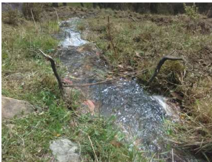
Figura 12: Progresiva 0+150 – Línea conducción se verifica la filtración Por el canal sin revestir.
