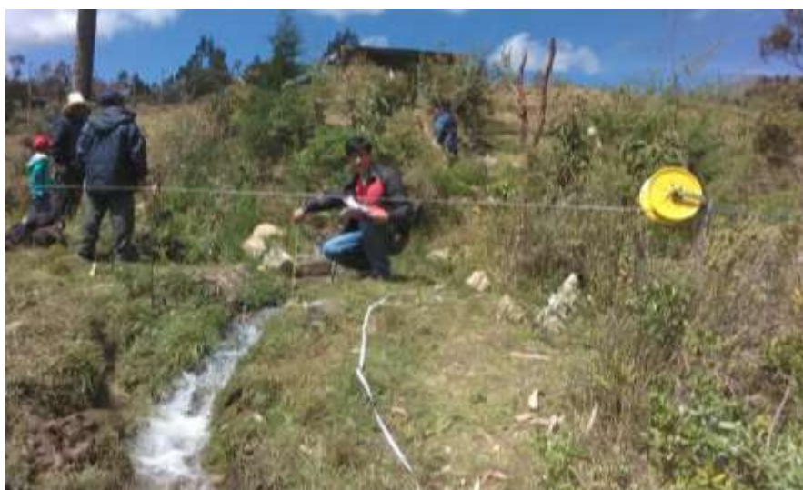
Figura 10: Progresiva 0+020 – Medición del caudal de entrada, en tramo de muestra línea de conducción.
