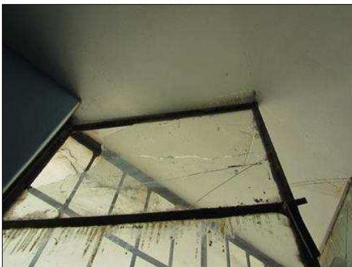
Ventana en mal estado Sala de Dilatación, Centro Obstétrico
