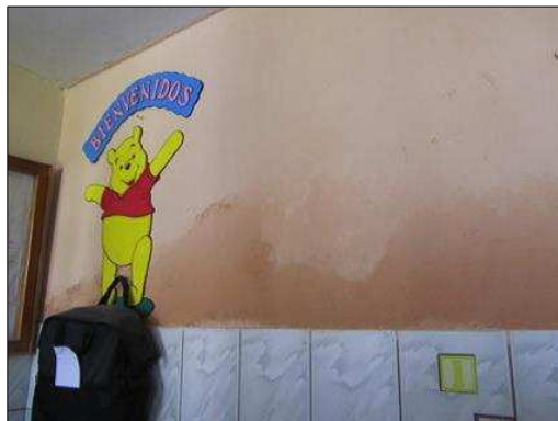
Muro con altos niveles de humedad CRED, Inmunizaciones
