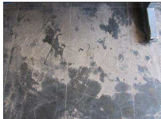
Piso en mal estado Consultorio de Adolescente, Centro Obstétrico
