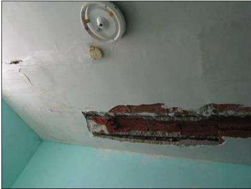
Estructura a punto de colapsar Sala de Operaciones, Centro Quirúrgico
