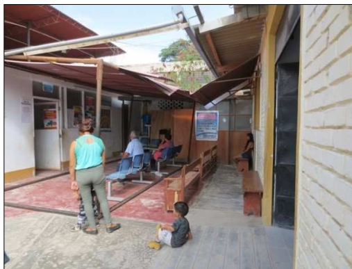
Calaminas a punto de caer Espera en Patio Secundario del establecimiento
