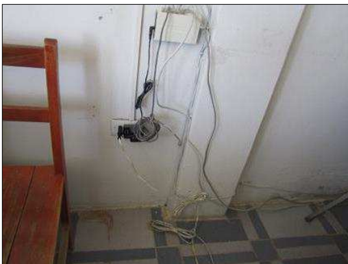
Desorden de cableado en salida de fuerza adosada Oficina de Estadística
