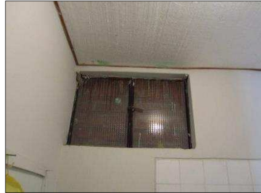
Techo de tecnoport en Servicios Higiénicos Hospitalización de Ginecología
