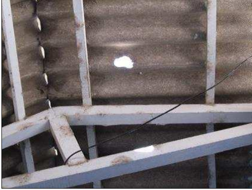
Agujeros en calaminas, permiten ingreso de lluvia Pasadizo de Consultorios Médicos
