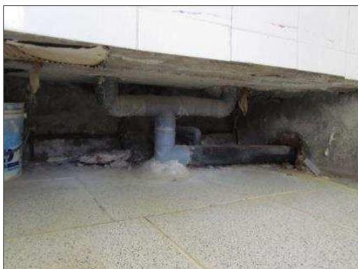
Tuberías adosadas en mal estado Laboratorio Tipo I-4
