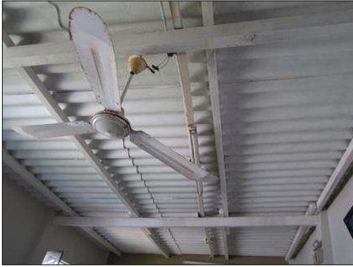
Ventilación adosada para obtener confort térmico Hospitalización de Ginecología
