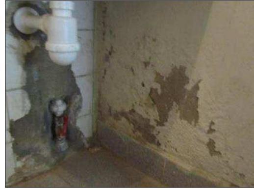
Tuberías adosadas en mal estado Hospitalización de Ginecología
