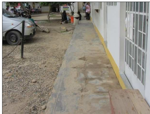
Veredas en mal estado Patio Principal del establecimiento
