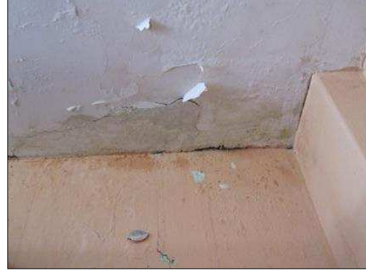
Daños en techo y muros por humedad Central de Esterilización
