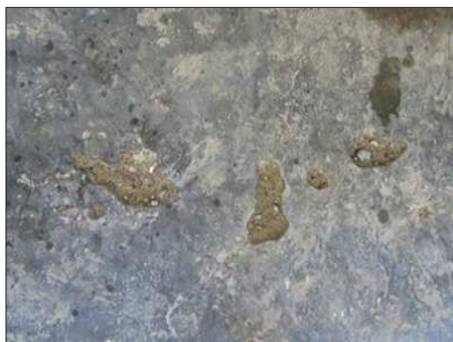
Daños en acabado de piso Farmacia
