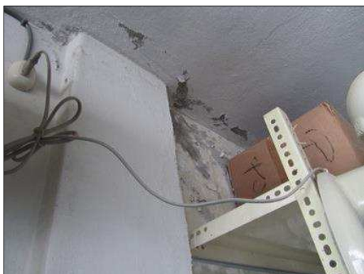
Daños en muros y techo Farmacia
