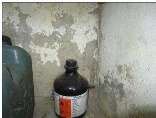
Daños en muros por salitre Laboratorio Tipo I-4
