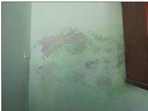
Muros con niveles altos de salitre Consultorio de Nutrición
