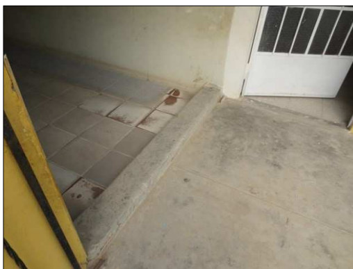
Inaccesibilidad para personas con discapacidad Pasadizo a Patio Principal del establecimiento
