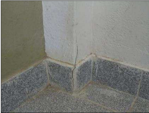
Daños estructurales en columnas Hospitalización de Ginecología
