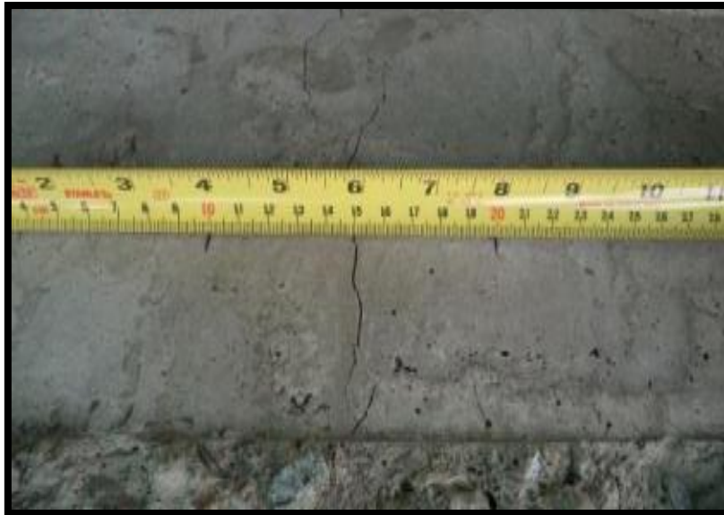
Figura 30: Presencia de fisura en muros del proyecto.
