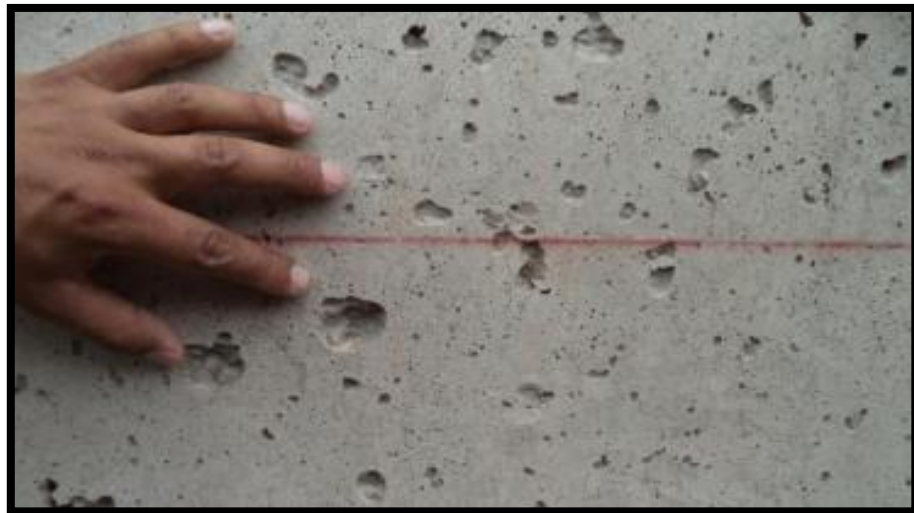
Figura 33: Muro con presencia de Burbujas
