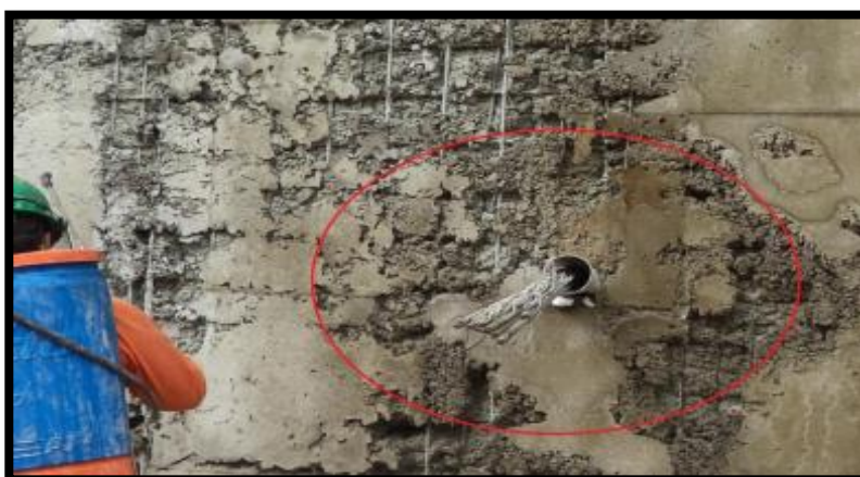
Figura 27: Cangrejera en la zona de refuerzo de anclaje
