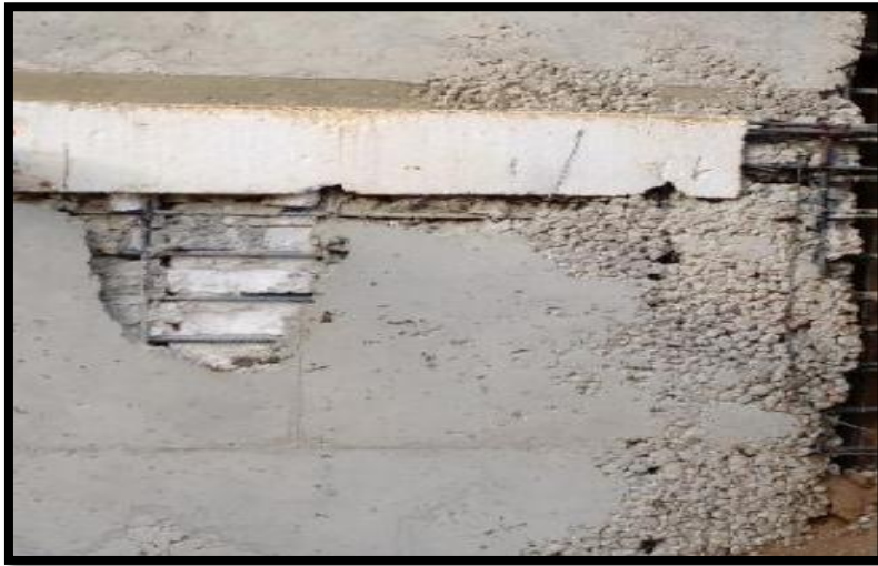
Figura 31: Segregación en muros.
