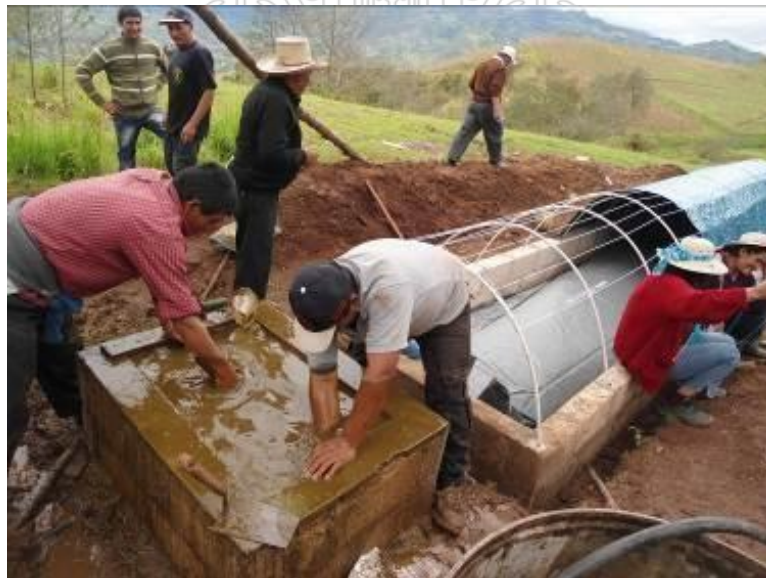
Foto 10: Carga del biodigestor
