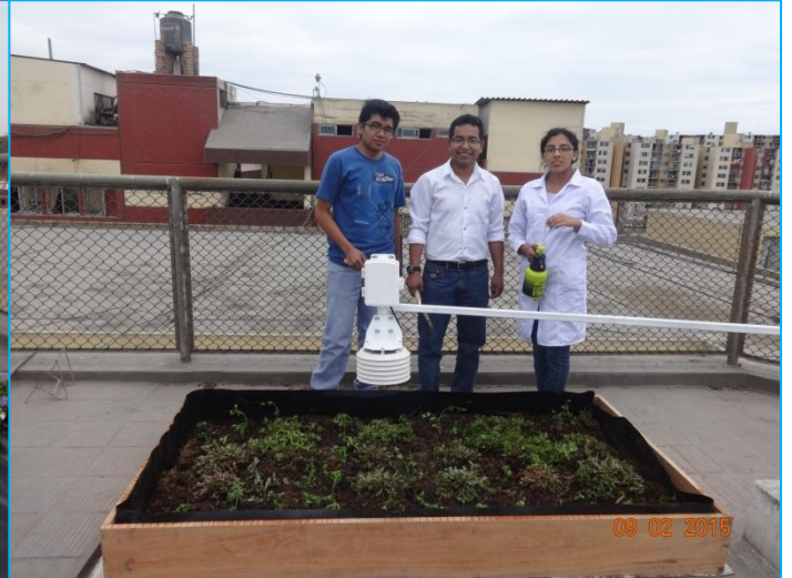
Fotografía N° 2: Instalación de especies vegetales en la celda preparada para la cubierta vegetal
