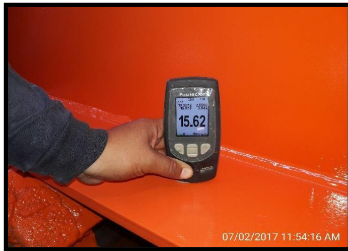
Figura 97 Determinación del espesor de la pintura.
