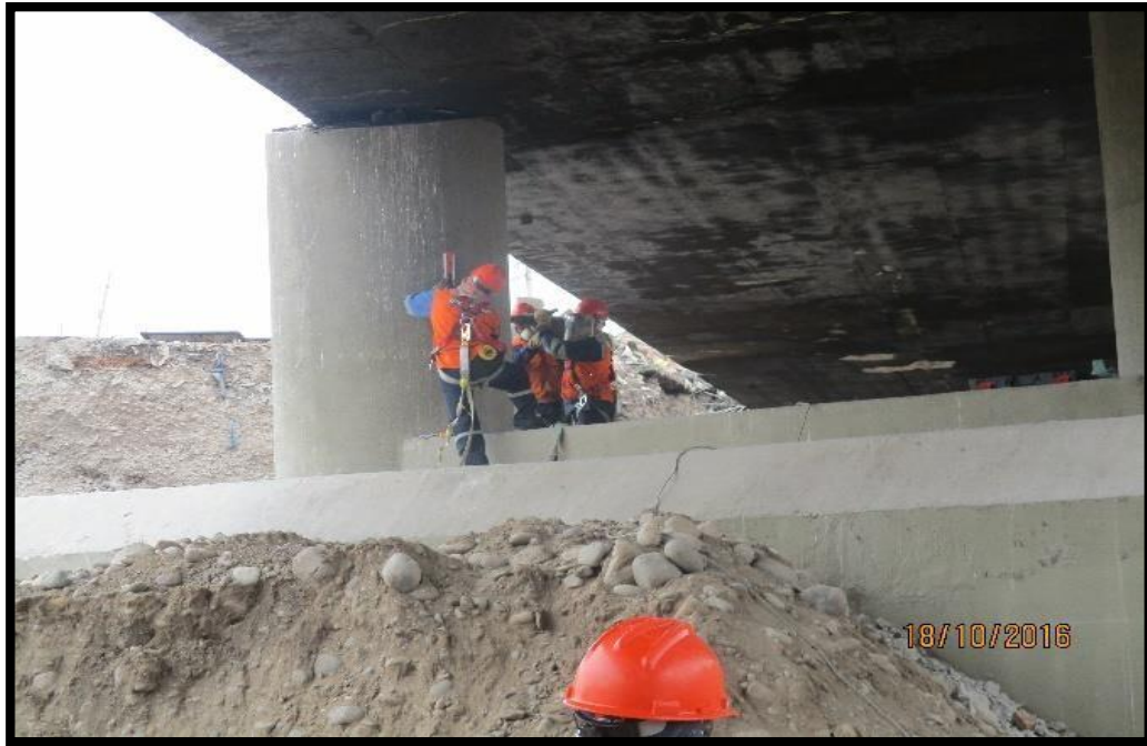
Figura 39 Debilitación de los pilares centrales
