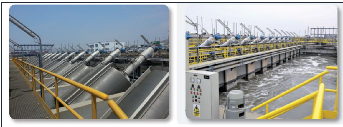
Figura 3. Instalaciones de planta de tratamiento Taboada-Sanemaiento de Lima Metropolitana Fuente: TEDAGUA (2014).
