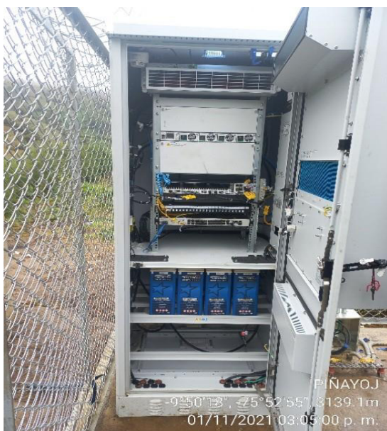
Gabinete de Transmisión
