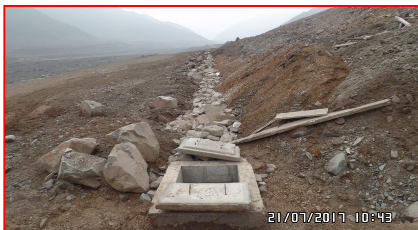
Dren de lixiviado y caja de inspección
